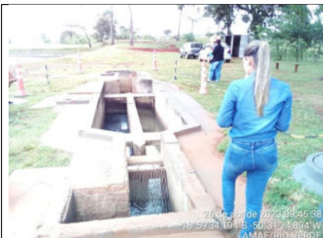
Autor: AMAE Descrição: Dois canais de tratamento preliminar, constituído por gradeamento, desarenação e calha Parshall.
