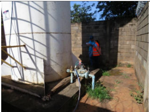
Autor: AMAE Descrição: Tubulação de entrada do poço e cloração.
