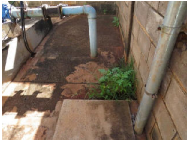
Autor: AMAE Descrição: Sem caixa de proteção.
