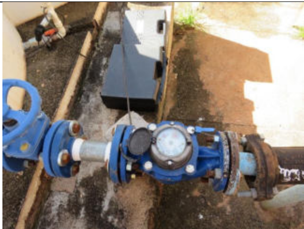
Autor: AMAE Descrição: Macromedidor de saída.
