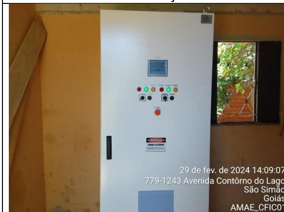
Autor: AMAE Foto: Novo quadro de comando da ETE Beira Lago
