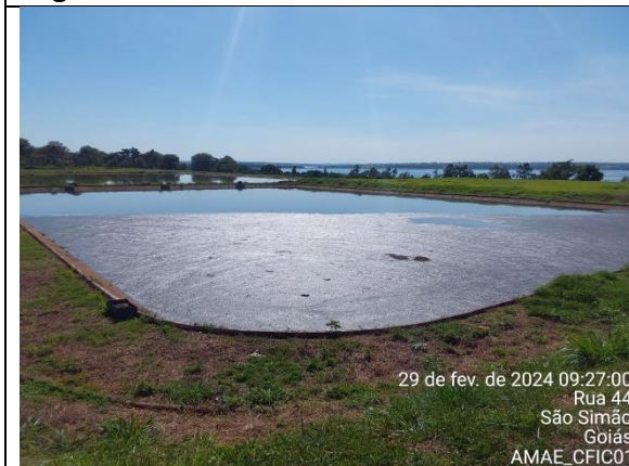
Autor: AMAE Foto: Acúmulo de material sobrenadante em lagoa da ETE
