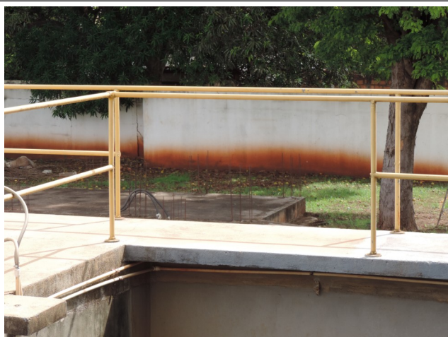
Autor: AMAE/RIO VERDE Descrição: Guarda-corpos com barra de proteção faltante
