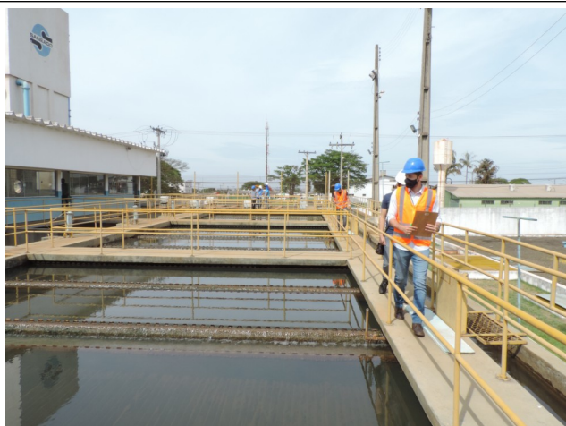
Autor: AMAE/RIO VERDE Descrição: Decantadores e filtros de tratamento.
