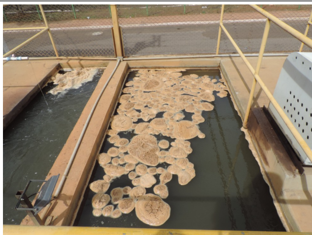
Autor: AMAE/RIO VERDE Descrição: Sistema de floculação
