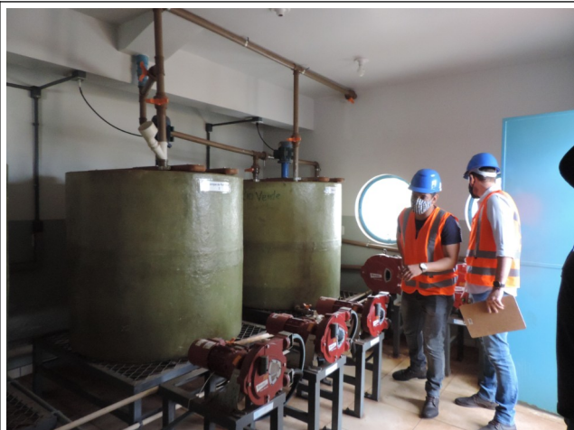
Autor: AMAE/RIO VERDE Descrição: Tanques de coagulação
