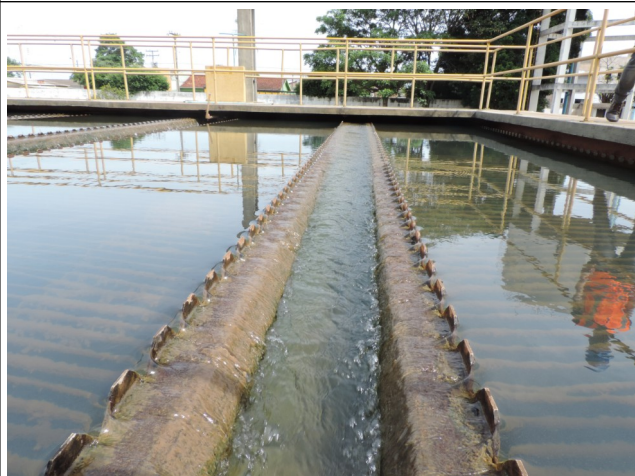
Autor: AMAE/RIO VERDE Descrição: Canaleta do decantador que direciona ao filtro.
