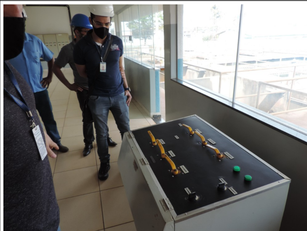
Autor: AMAE/RIO VERDE Descrição: sistema autônomo de lavagem dos filtros
