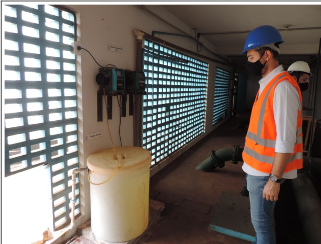
Autor: AMAE/RIO VERDE Descrição: tanque de reservação de Flúor
