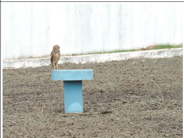
Autor: AMAE/RIO VERDE Descrição: duto de ventilação do reservatório enterrado com tampa.
