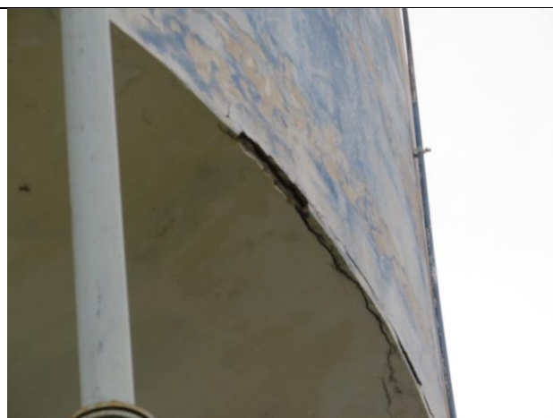
Autor: AMAE Descrição: Detalhe de uma rachadura no REL
