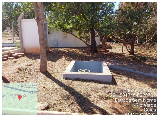
Figura 6 – Elemento fiscalizado: EEAB Central.
