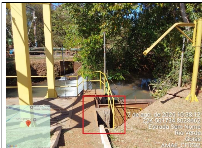
Figura 5 – Elemento fiscalizado: EEAB Central.
