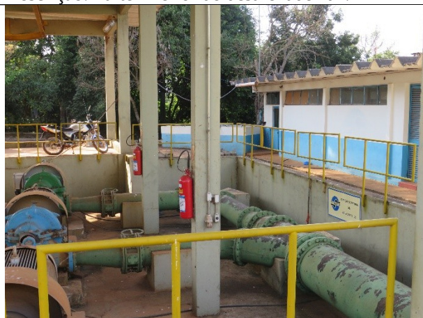
Autor: AMAE/RIO VERDE Descrição: Elevatória para adução com destino à ETA.
