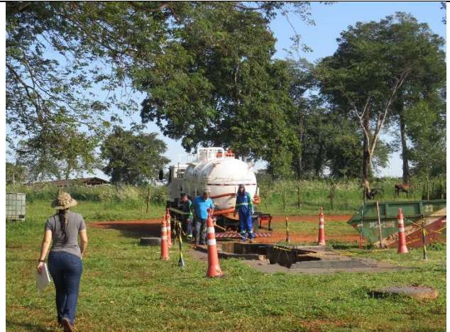
Autor: AMAE Descrição: Jatway descartando esgoto antes do gradeamento na ETE.
