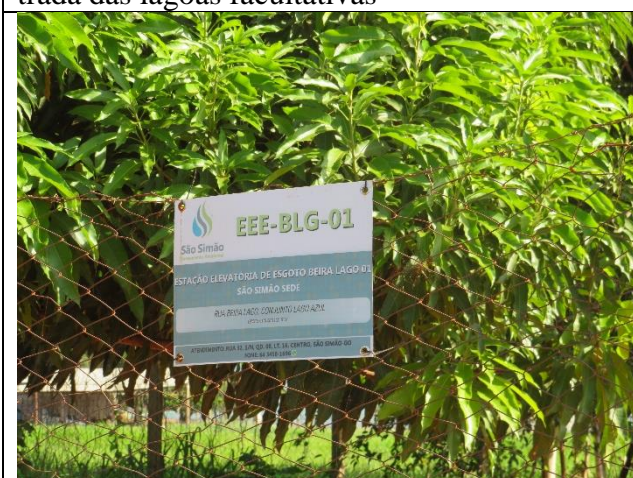
Autor: AMAE Descrição: Placa de identificação da Estação Elevatória de Esgoto.
