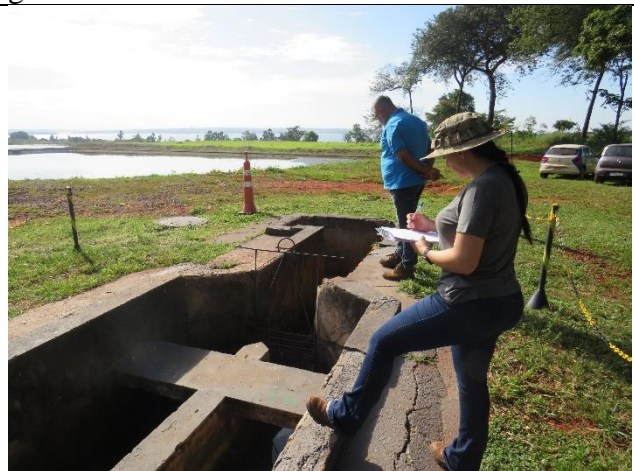
Autor: AMAE Descrição: Calha Parshall sem medição.
