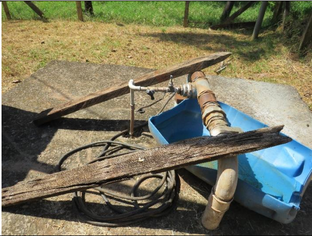
Autor: AMAE Descrição: Identificação de poço 06 Colombo com derivação.
