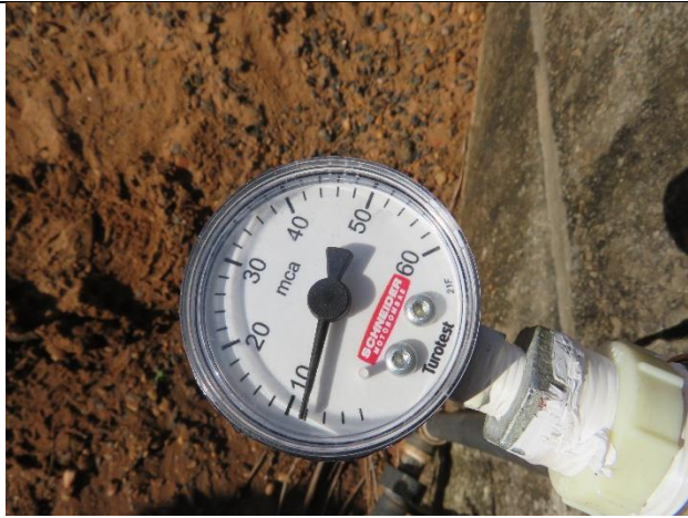
Autor: AMAE Descrição: Aferição de pressão em rede.
