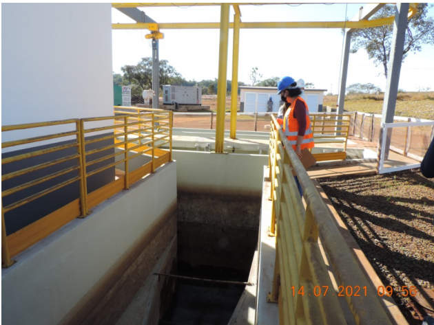
Autor: AMAE/RIO VERDE Descrição: Calha Parshall da EEE Sapo.
