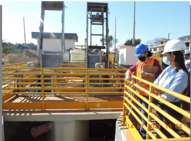
Autor: AMAE/RIO VERDE Descrição: Vala de chegada do efluente na EEE.
