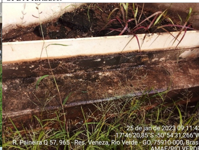
Autor: AMAE Descrição: REL VENEZA – Observar em 90 dias se identifica vazamento ou se trata de água acumulada de chuva.
