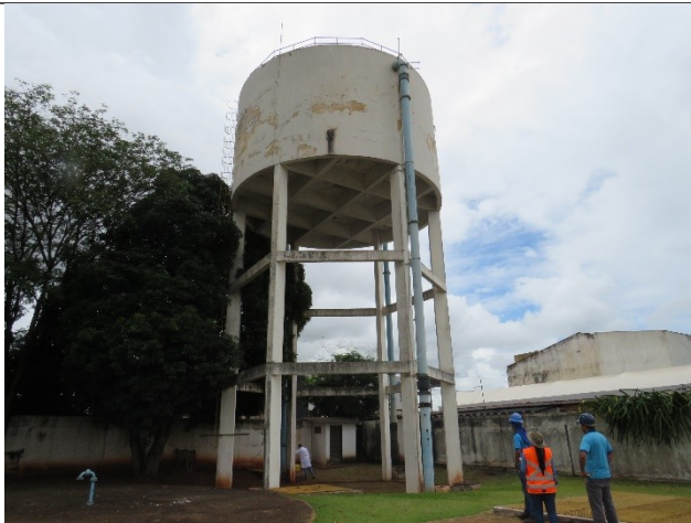
Autor: AMAE Descrição: REL Zona Alta I, “mancha de fissura na parede”.
