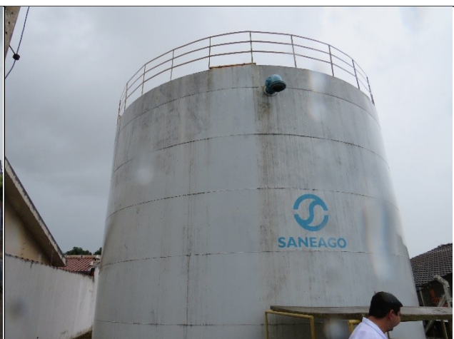
Autor: AMAE Descrição: RAP MARANATA – Duto de ventilação sem tela de proteção.
