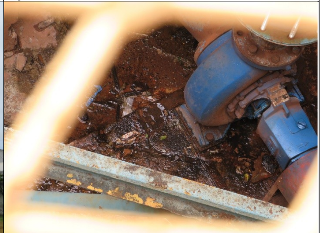
Autor: AMAE Descrição: REL Zona Alta I, “vazamento na gaxeta”.
