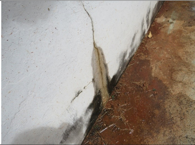
Autor: AMAE Descrição: RST ASSARV – reincidência de rachaduras e vazamentos
