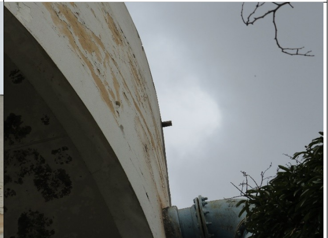
Autor: AMAE Descrição: REL Zona Alta I, sem proteção no suspiro.
