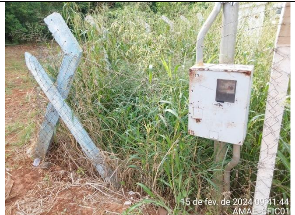
Autor: AMAE Foto: Cercamento rompido e mato alto no Poço PBG 07.
