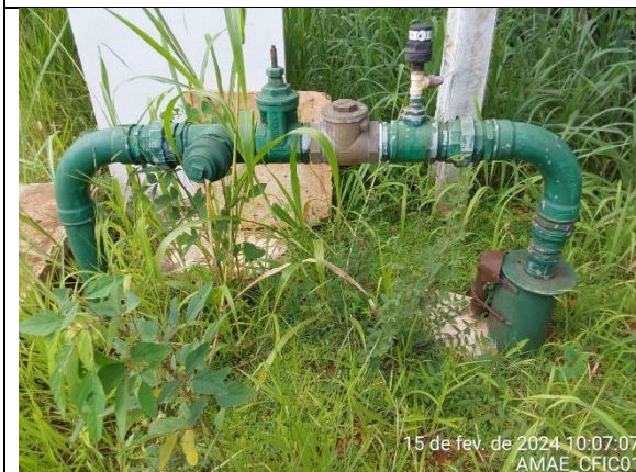
Autor: AMAE Foto: Poço PBG 08 sem laje de proteção.
