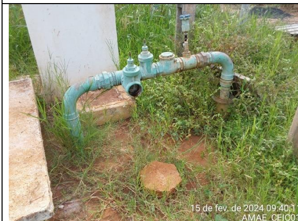
Autor: AMAE Foto: Poço PBG 07 sem laje de proteção.
