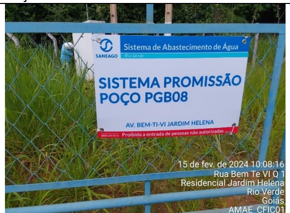
Autor: AMAE Foto: Placa de identificação e mato alto no Poço PGB 08.
