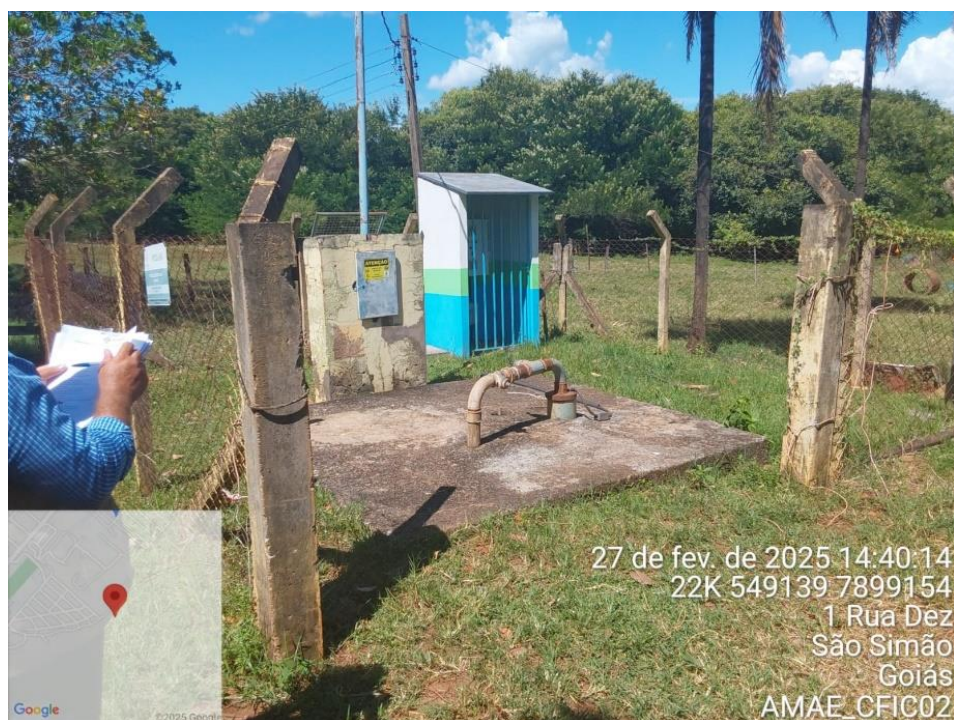
Autor: AMAE: Poço Colombo 06 – Ausência de portão com cadeado na entrada.
