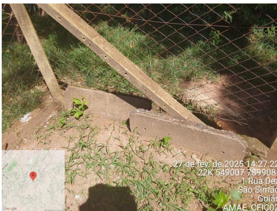
Autor: AMAE: Poço Colombo 05 – Parte da tela com buraco na parte inferior.
