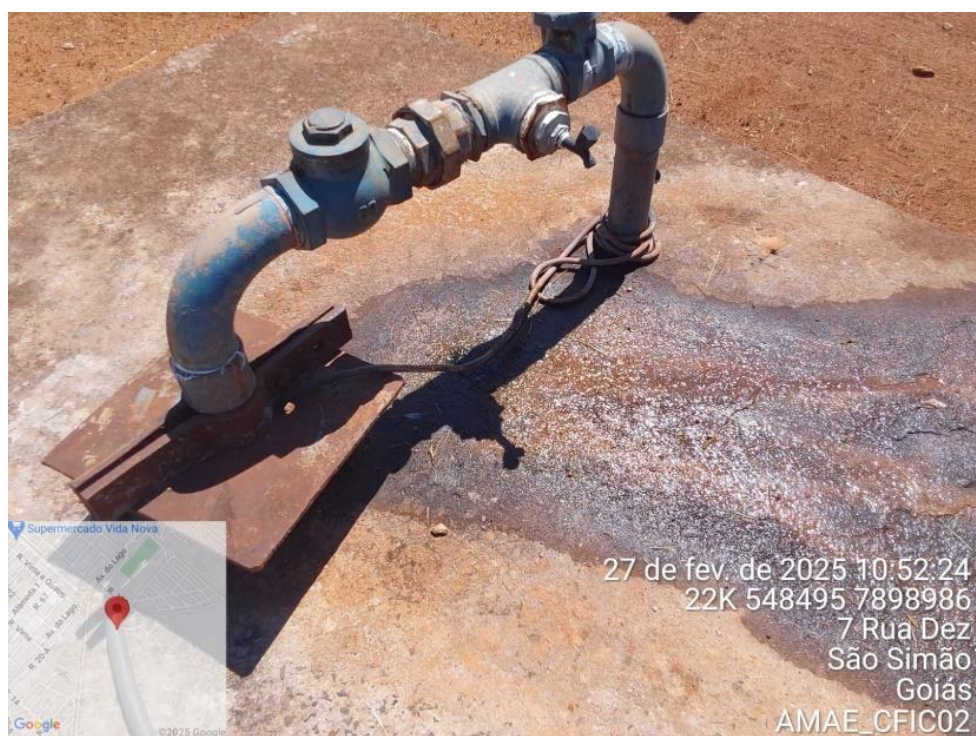
Autor: AMAE: Poço Colombo 01 – Vazamento na conexão.
