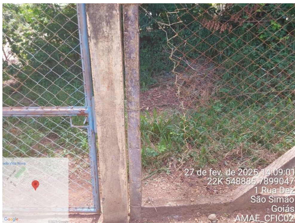
Autor: AMAE: Poço Colombo 04 – Cercamento em tela danificado.
