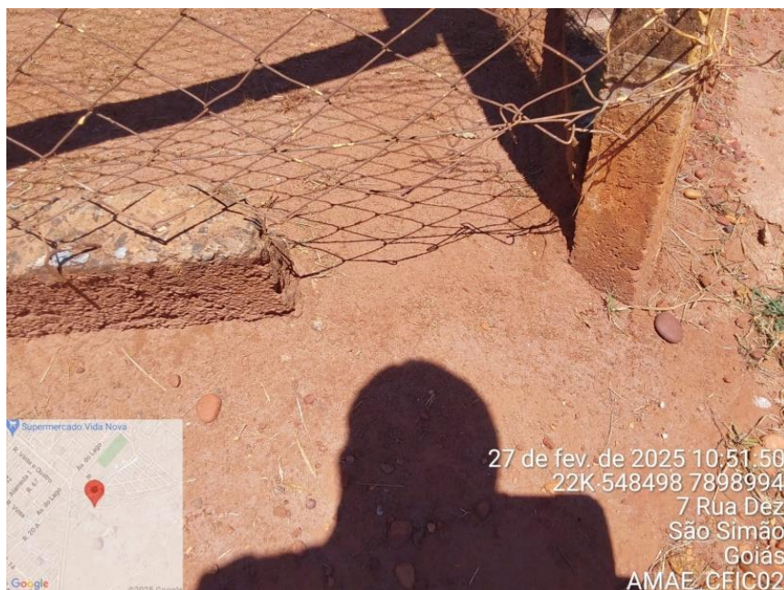
Autor: AMAE: Poço Colombo 02 – Tela com buracos próximo ao piso.
