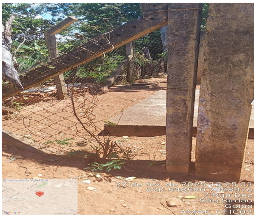
Autor: AMAE: Poço Colombo 02 – Telas comprometidas com buracos.
