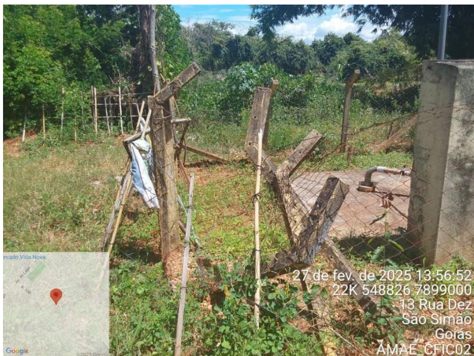
Autor: AMAE: Poço Colombo 03 – Cercamento caído (alambrados e telas).
