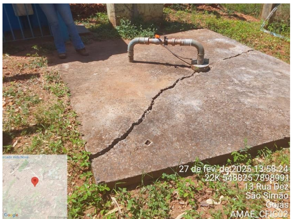
Autor: AMAE: Poço Colombo 03 – Laje sanitária rachada.
