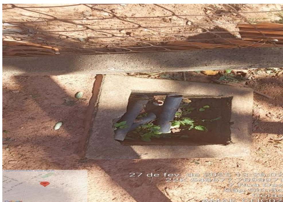
Autor: AMAE: Poço Colombo 02 – Caixa de passagem elétrica sem tampa.
