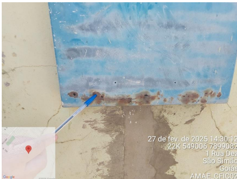
Autor: AMAE: Poço Colombo 05 – Corrosão na tampa da caixa elétrica (buracos), aferindo risco choque.
