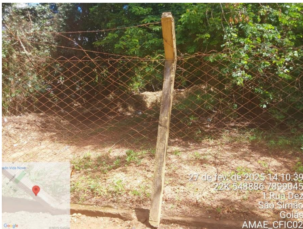
Autor: AMAE: Poço Colombo 04 – Cercamento (poste do alambrado cisalhado na parte inferior.
