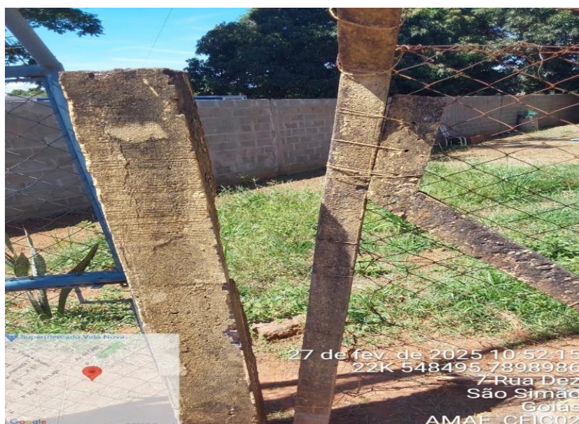
Autor: AMAE: Poço Colombo 10 – Cercamento comprometido.
