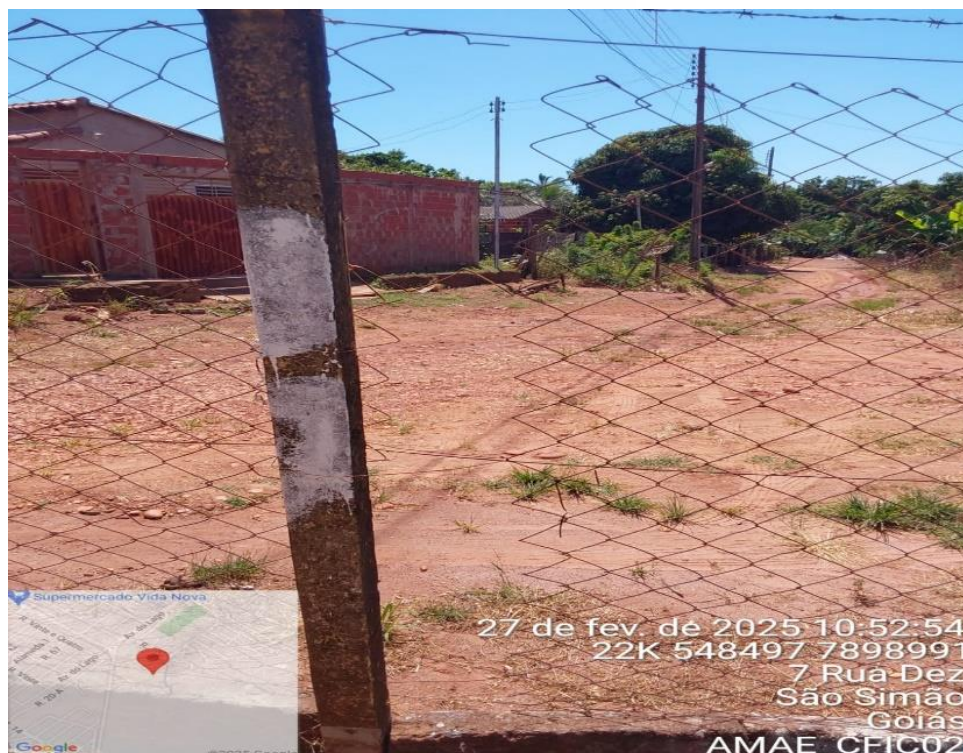
Autor: AMAE: Poço Colombo 01 – Tela danificada com abertura vertical.
