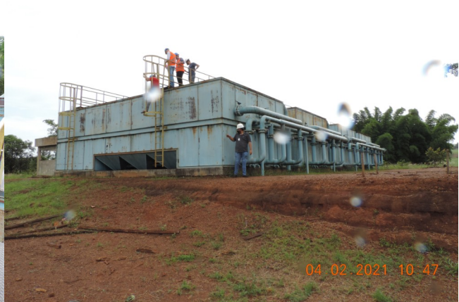
Autor: AMAE/Rio Verde Descrição: Equipamentos seguem sem instalação completa e são necessários à ampliação
