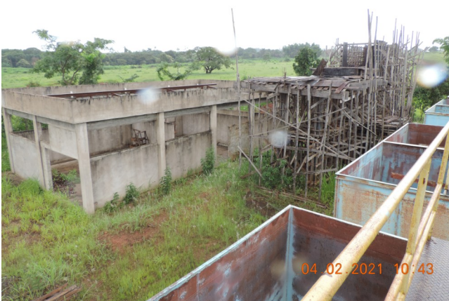
Autor: AMAE/Rio Verde Descrição: Obras carecem de intervenção para reativação
