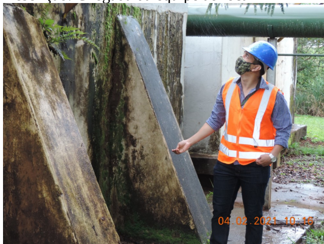
Autor: AMAE/Rio Verde Descrição: Desarenador com lodo
