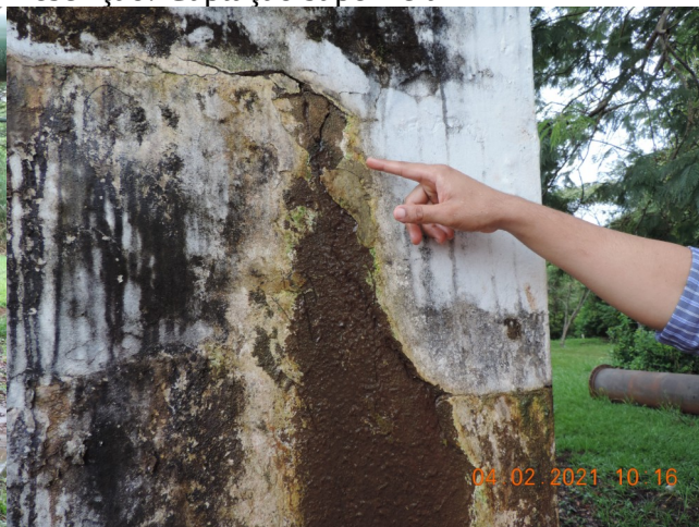
Autor: AMAE/Rio Verde Descrição: Rachadura em desarenador
