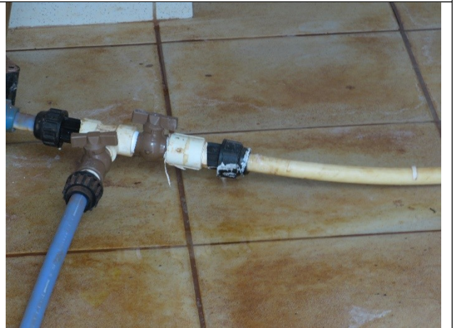
Autor: AMAE Descrição: Vazamento no clorador do REL Água Santa.
