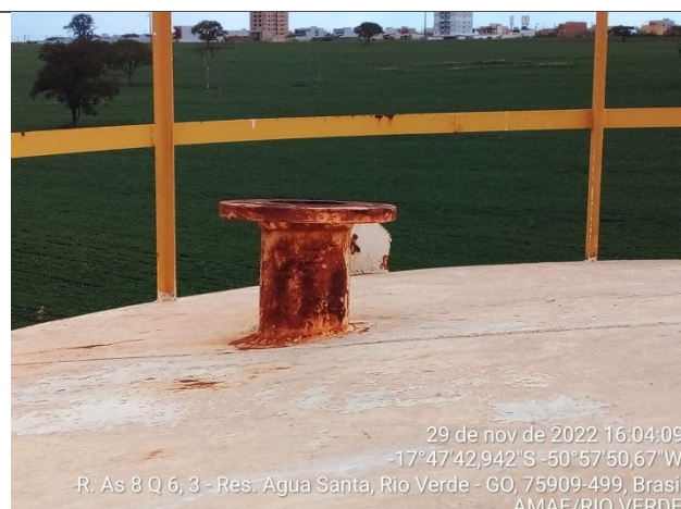
Autor: AMAE Descrição: REL Água Santa. Sem proteção no suspiro que também apresenta corrosão.
