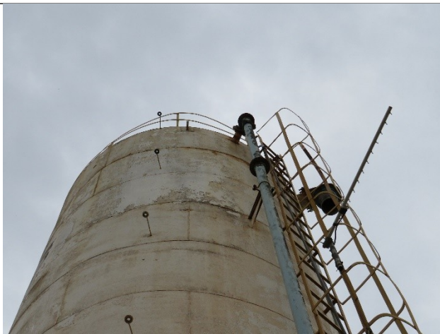
Autor: AMAE Descrição: REL Água Santa sem cabos de aterramento e sem para-raios.
