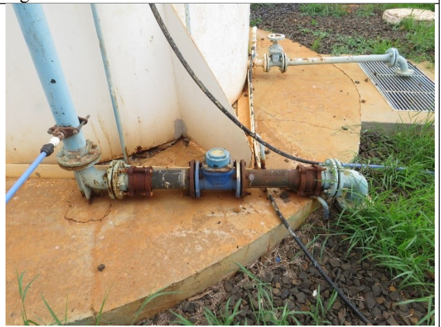
Autor: AMAE Descrição: Macromedidor sem casa de proteção e tubulações em alto nível de corrosão no REL Água Santa.
