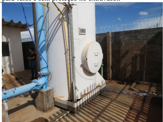
Autor: AMAE Descrição: REL Goiânia sem cabo de aterramento.
