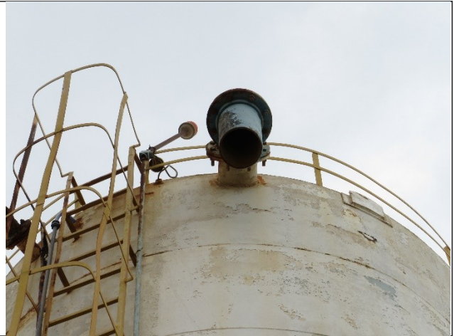
Autor: AMAE Descrição: Boca do extravasor sem proteção no REL Água Santa.
