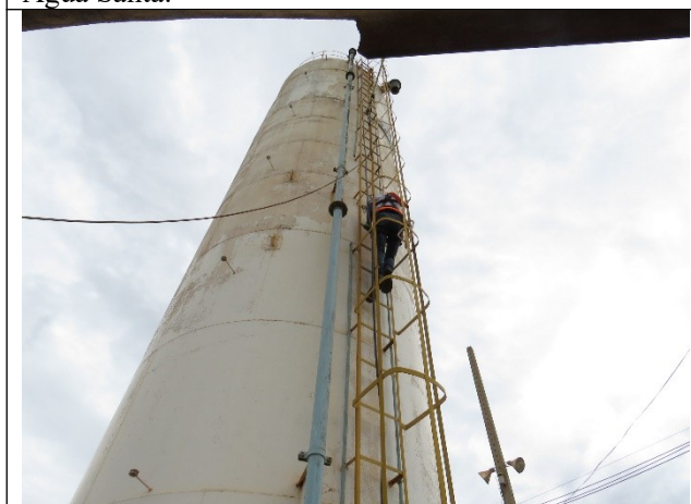
Autor: AMAE Descrição: Escadas de acesso a parte superior do REL Água Santa fora dos padrões para escada Marinheiro.
