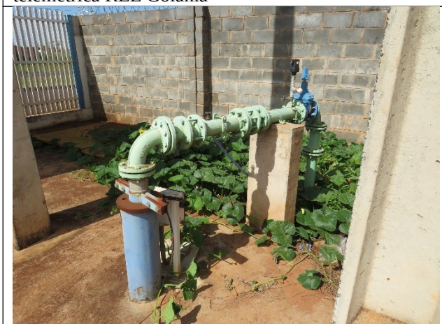
Autor: AMAE Descrição: Falta de limpeza REL Goiânia.
