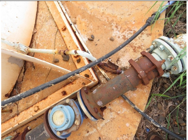
Autor: AMAE Descrição: Alto nível de corrosão na tubulação de material metálico que deveria proteger cabos elétricos no REL Água Santa
