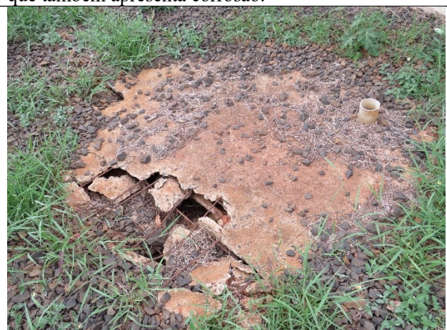
Autor: AMAE Descrição: Falta de limpeza e manutenção no REL Água Santa.
