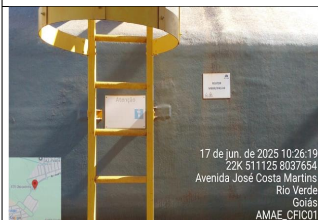
Autor: AMAE – figura 3. Foto: Placas de identificação e sinalização deterioradas/apagadas nos reatores.
