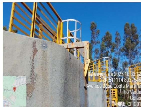
Autor: AMAE – figura 2. Foto: Estruturas de aço das transversinas com processo corrosivo avançado.
