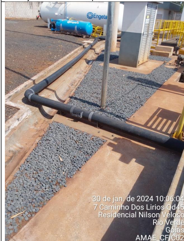
Fonte: AMAE Descrição: Tubulação que encaminha efluente para desodorizador.
