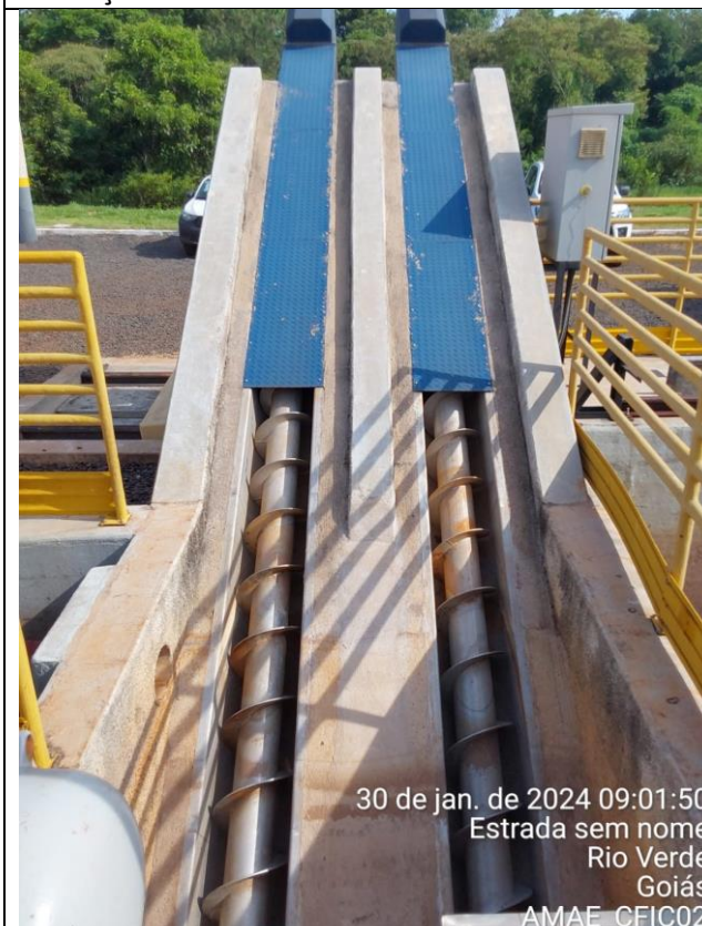
Fonte: AMAE Descrição: Remoção de sólidos por sistema de rosca.
