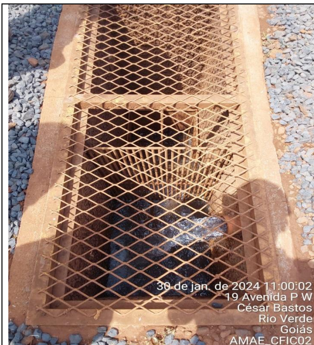
Fonte: AMAE Descrição: Equipe técnica da BRK e Saneago que acompanhou fiscalização na EEE Chapadinha.
