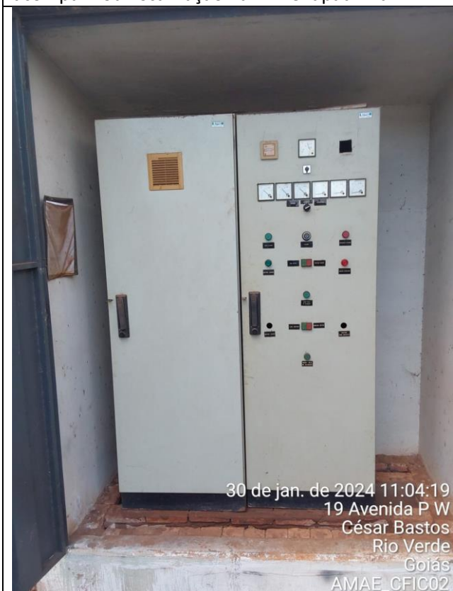
Fonte: AMAE Descrição: Quadro de comando da EEE Rinco.
