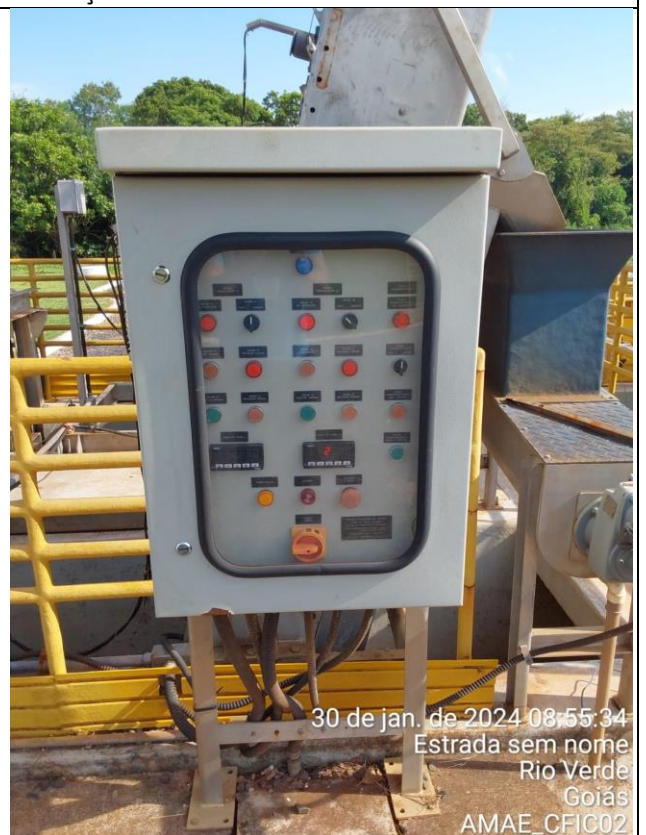
Fonte: AMAE Descrição: Quadro de comando.
