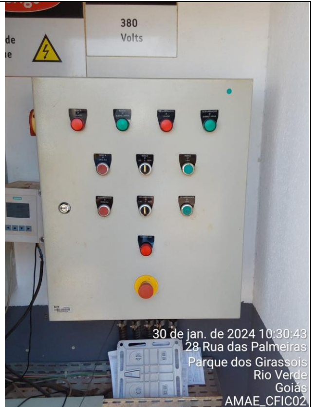
Fonte: AMAE Descrição: Quadro de comando.
