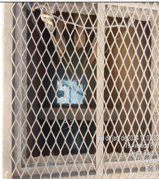
Fonte: AMAE Descrição: Tubulação da linha de recalque que seguirá para ETE Laje.
