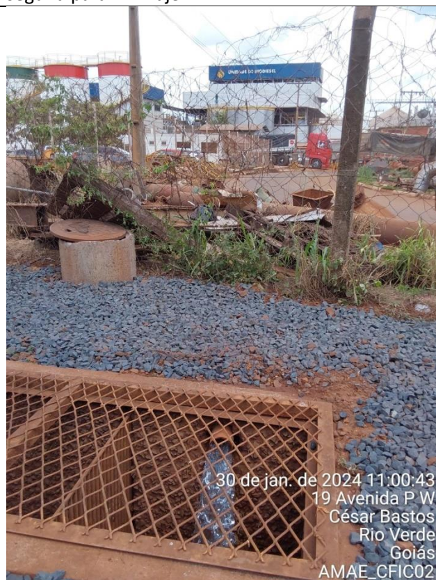
Fonte: AMAE Descrição: Tubulação da caldeira da indústria Cereal Ouro que cai na elevatória.
