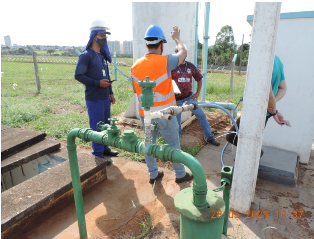
Autor: AMAE/RIO VERDE Descrição: Poço profundo PGB 02 - Cachamba
