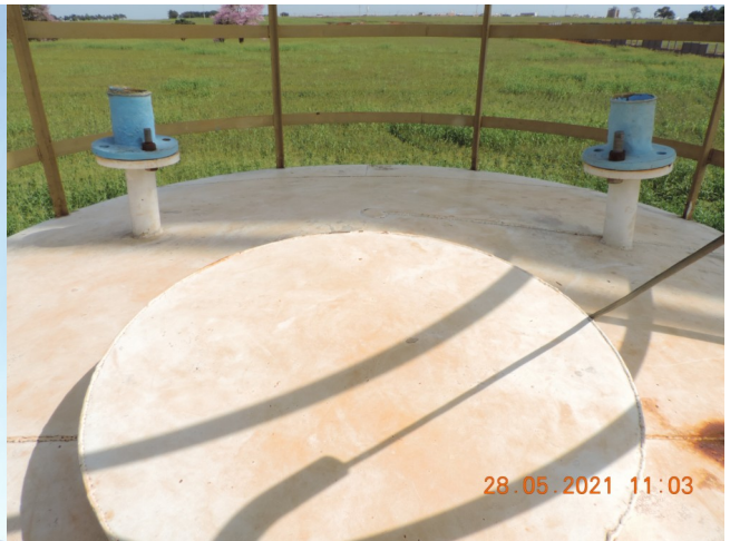
Autor: AMAE/RIO VERDE Descrição: Dutos de ventilação no alto do reservatório sem tela de proteção.
