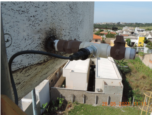
Autor: AMAE/RIO VERDE Descrição: Sensor telemétrico na base do reservatório.
