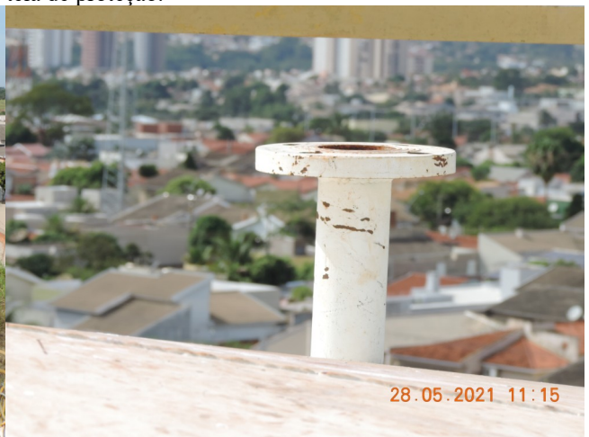
Autor: AMAE/RIO VERDE Descrição: Duto de ventilação no alto do reservatório sem tela de proteção.
