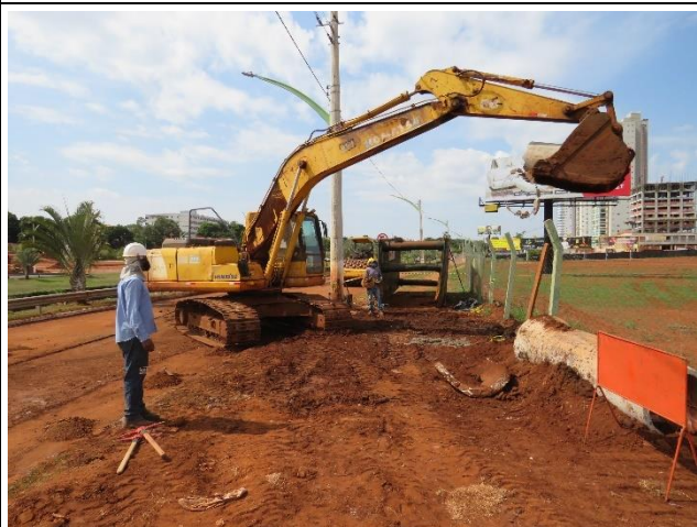
Autor: AMAE/RIO VERDE Descrição: Etapa final de interligação/ampliação da rede coletora SES Sapo – Av. Deputado Paulo Roberto Cunha em 11/05/2022.
