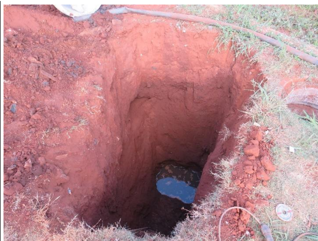
Autor: AMAE/RIO VERDE Descrição: Registro de extravasamento de esgoto sanitário no solo em 09/05/2022.
