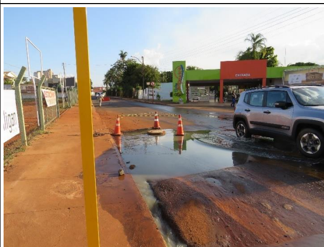
Autor: AMAE/RIO VERDE Descrição: extravasamento de esgoto sanitário na via ocasionado pelo bloqueio de PV para não interferir no PV reparado a jusante (10/05/2022)
