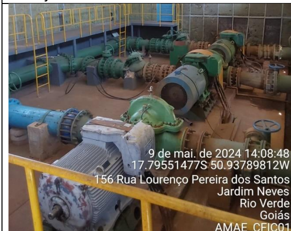
Autor: AMAE Foto: Casa de bombas do Booster Abóbora
