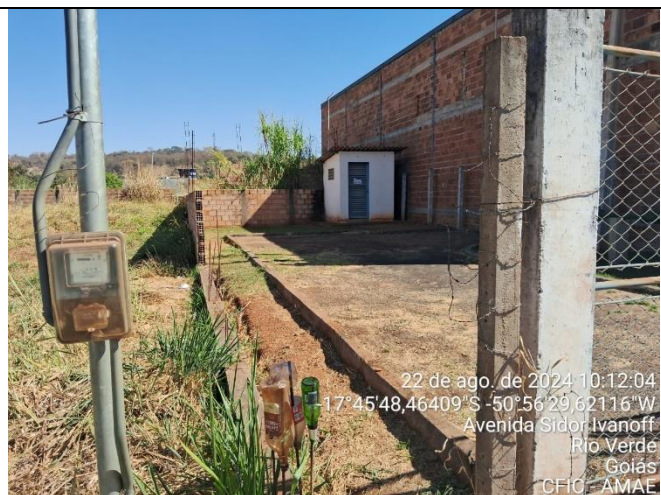
Fonte: AMAE Descrição: Poço PBV-01 Bela Vista – Cercamento/isolamento inacabado.
