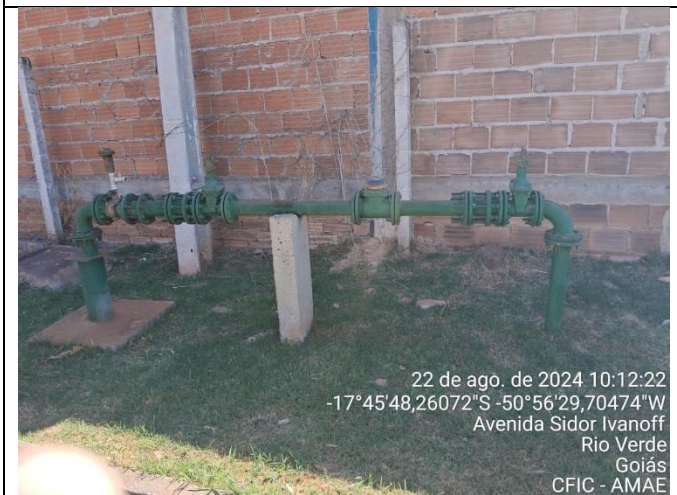
Fonte: AMAE Descrição: Poço PBV-01 Bela Vista – Macromedidor.
