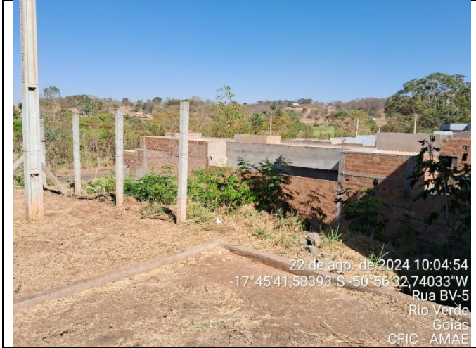
Fonte: AMAE Descrição: Poço PBV-02 Bela Vista – Cercamento/isolamento inacabado.
