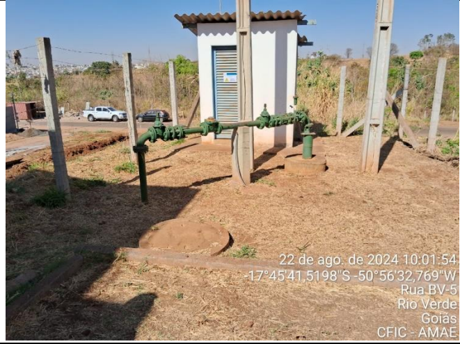
Fonte: AMAE Descrição: Poço PBV-02 Bela Vista – Macromedidor.
