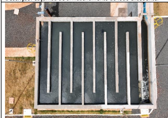
Figura. 9 – Elemento Fiscalizado: ETE Laje. Descrição: Tanque de contato.
