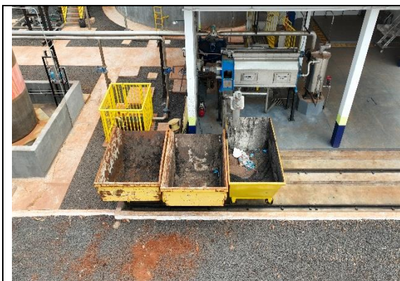
Figura. 7 – Elemento Fiscalizado: ETE Laje. Descrição: Caçamba de armazenamento do lodo excedente.
