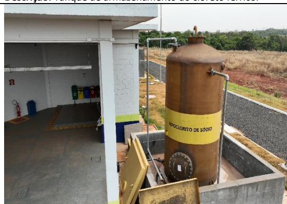
Figura. 10 – Elemento Fiscalizado: ETE Laje. Descrição: Tanque de armazenamento do hipoclorito de sódio.
