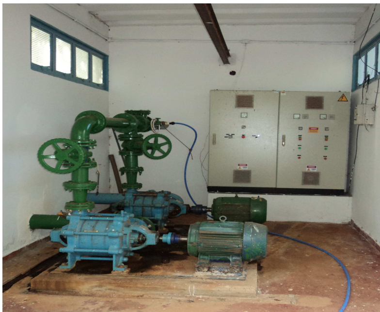
Figura 14 – Conjunto Moto-bomba da EEAB
