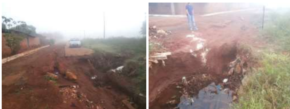
Figura 30 - Área de risco E02
