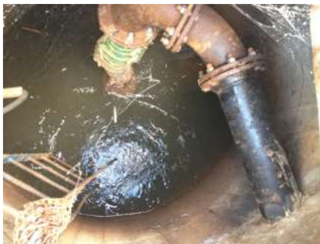
Poço de Sucção
