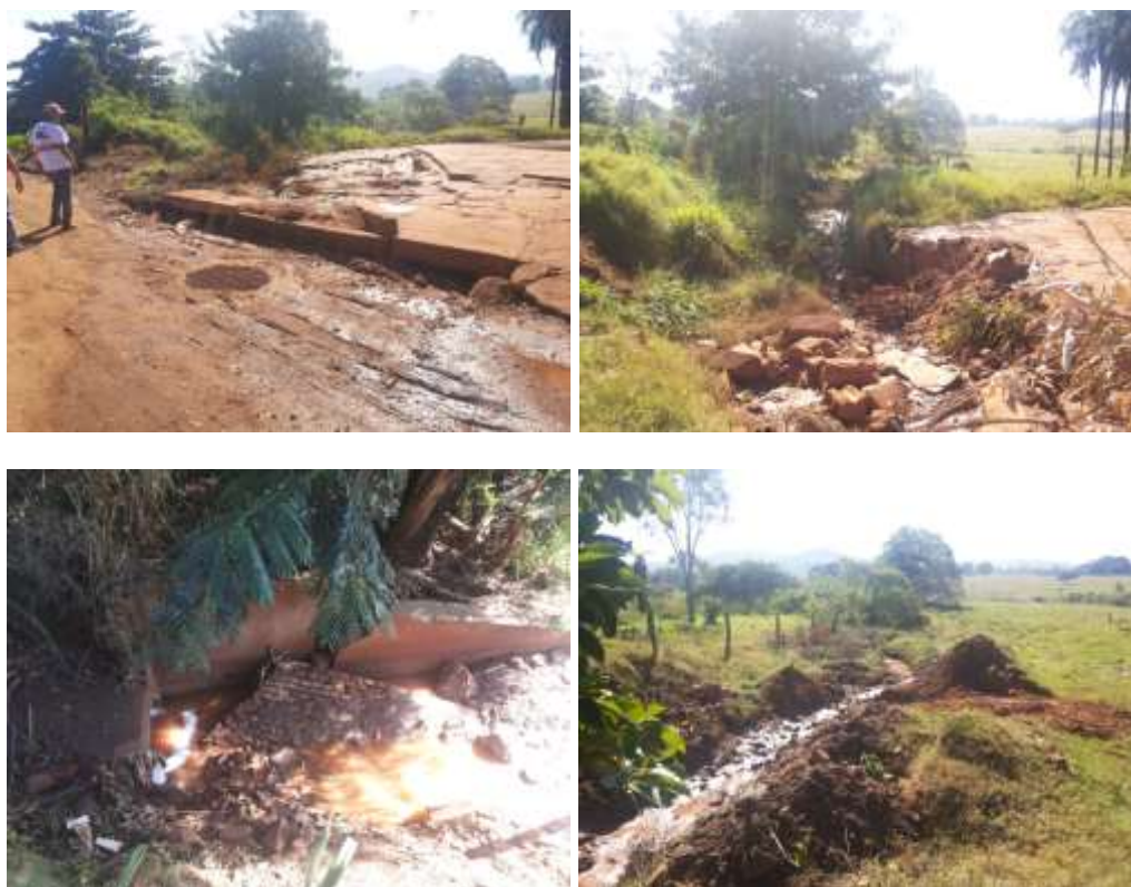
Figura 29 - Área de risco E01
