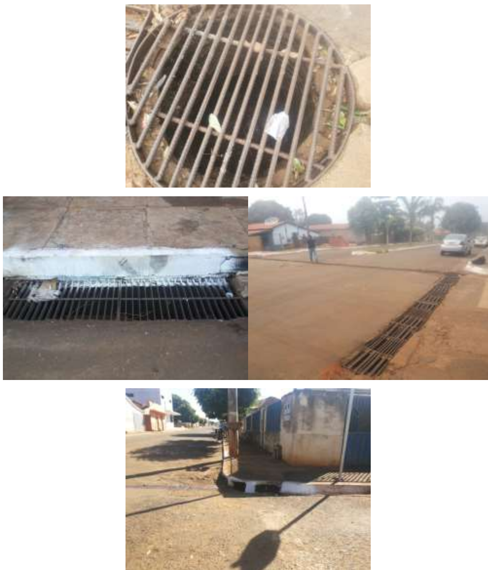
Figura 20 - Equipamentos de microdrenagem
