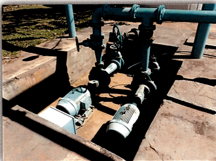
Figura 9: Estação Elevatória de Água Bruta
