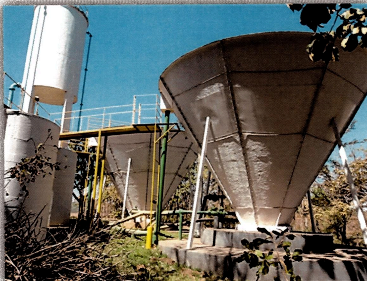
Figura 13: Floccodecantadores da ETA
