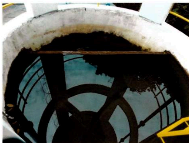
Figura 9 - Sistema de Filtragem – 2014. Fonte: Geoplano.
