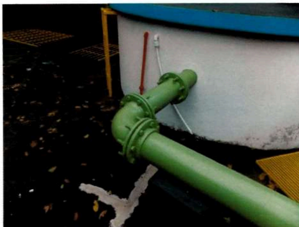
Figura 14 - Reservatório de Contato – 2014. Fonte: Geoplano
