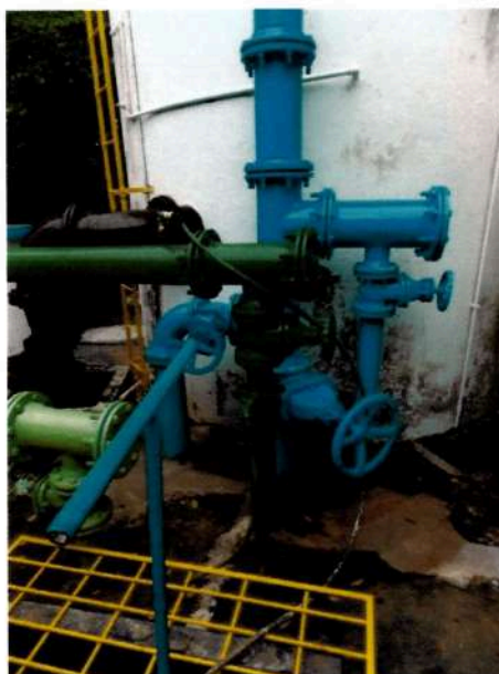
Figura 10 - Válvula Controle de Vazão – 2014. Fonte: Geoplano.
