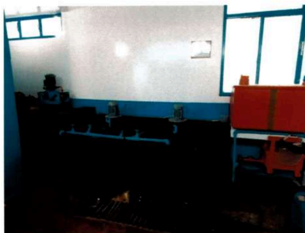
Figura 11 - Câmara de Aplicação de Produtos Químicos – 2014. Fonte: Geoplano.
