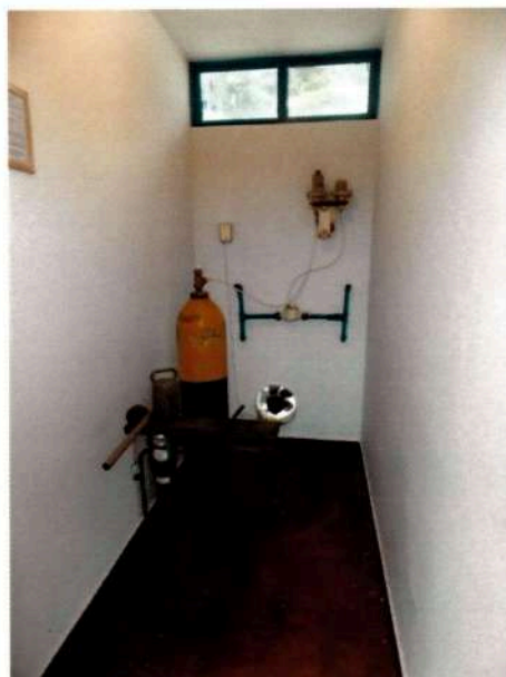
Figura 12 – Equipamento de Tratamento – 2014. Fonte: Geoplano.
