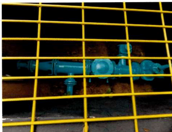
Figura 16 - Caixa de Manobra de Saída – 2014. Fonte: Geoplano
