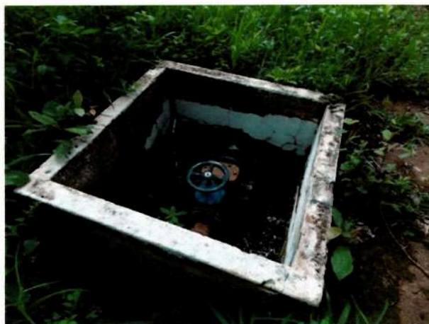
Figura 8 - Caixa de Manobra – 2014. Fonte: Geoplano.
