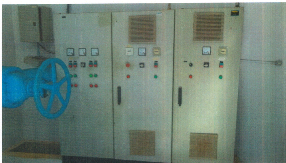
Figura 2.1.3.3-2. Painéis de controle do sistema de bombeamento.
