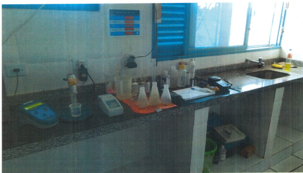
Figura 2.1.4-1. Laboratório instalado na ETA de Edealina.
