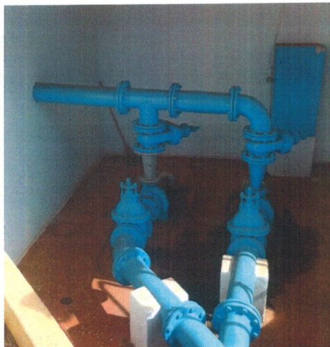
Figura 2.1.3.4-3. Sistema de bombeamento de água do reservatório apoiado para o elevado.
