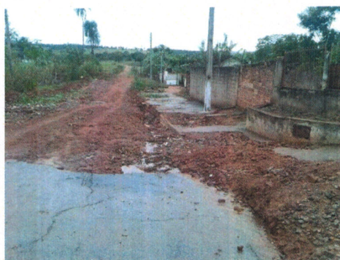
Figura 2.3-2. Acúmulo de barro e água na via por falta de drenagem superior e inferior
