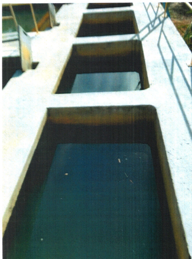
Figura 2.1.3.2-4. Filtros de areia, brita e cascalho utilizados na ETA.
