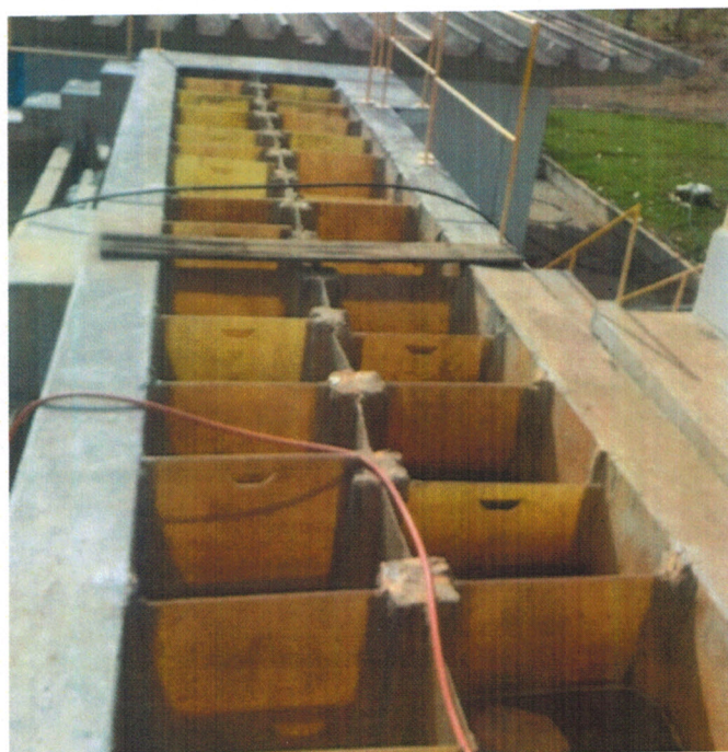
Figura 2.1.3.2-2. Tanque de floculação, com chicane.
