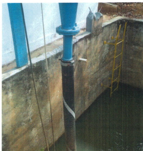
Figura 2.1.3.1-2. Bomba submersa que atua na captação de água.
