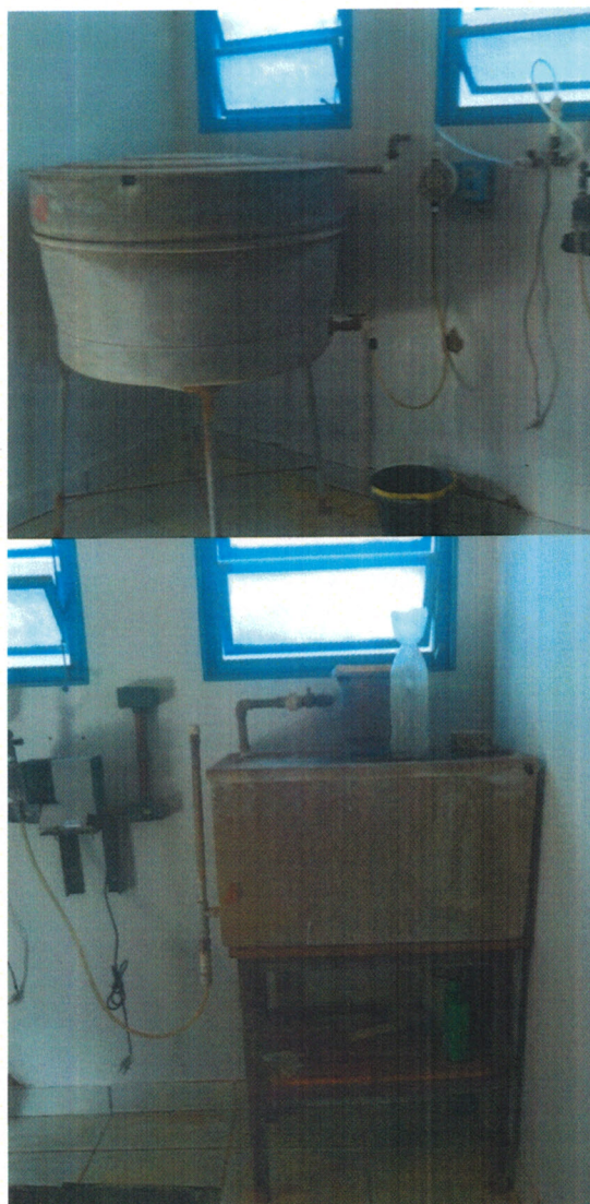
Figura 2.1.3.5-5 e 6. Sistemas de dosagem de cloro e flúor na água tratada.
