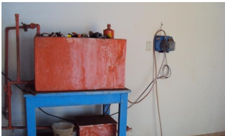
Foto : equipamentos de desinfecção da água na ETA
