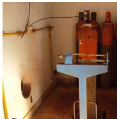
Foto : equipamentos de desinfecção da água na ETA
