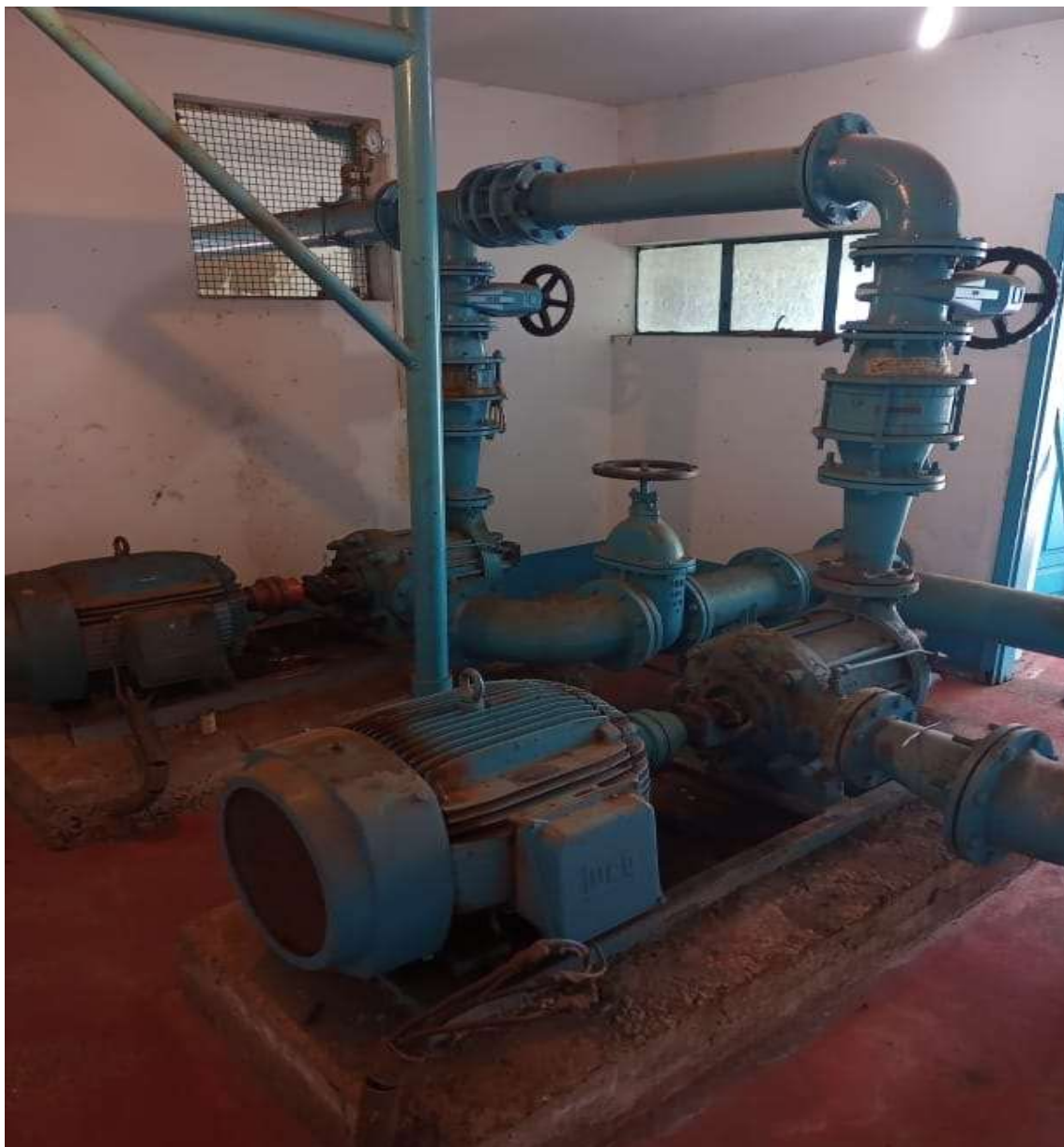
Figura 6– Conjunto Moto-Bombas Fonte: SANEAGO
