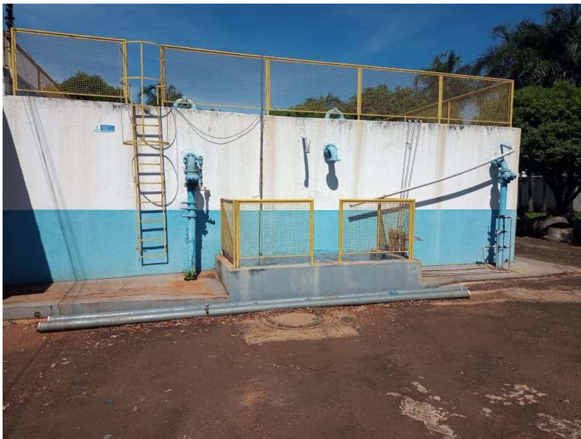
Figura 7 – ETA e Reservatório Fonte: SANEAGO
