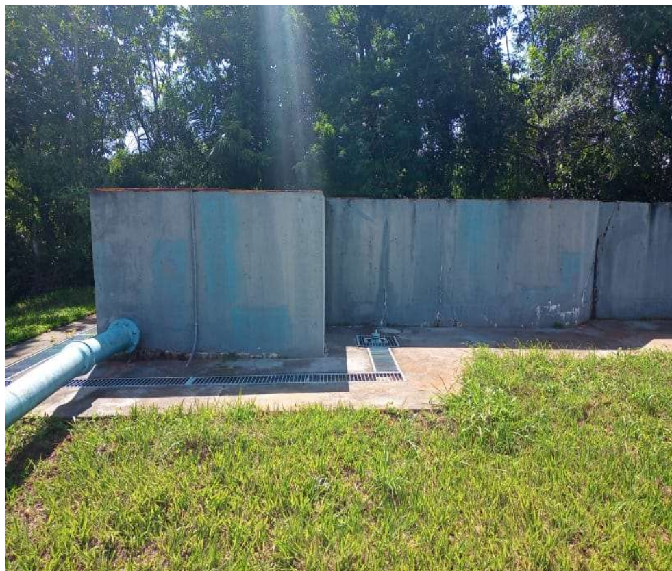
Figura 5: Casa de bombas e a caixa de areia. Localização na fazenda Pontal São João. Fonte: SENEAGO
