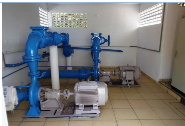
FIGURA 66 – CASA DE BOMBAS
