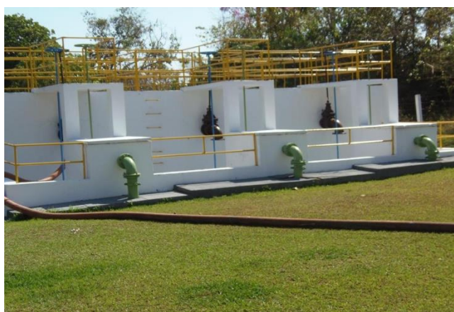
FIGURA 64 – ESTAÇÃO DE TRATAMENTO DE ÁGUA DE ITAPIRAPUÃ.
