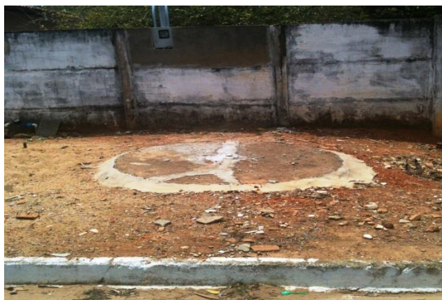
FIGURA 81 – FOSSA NEGRA RESIDENCIAL.
