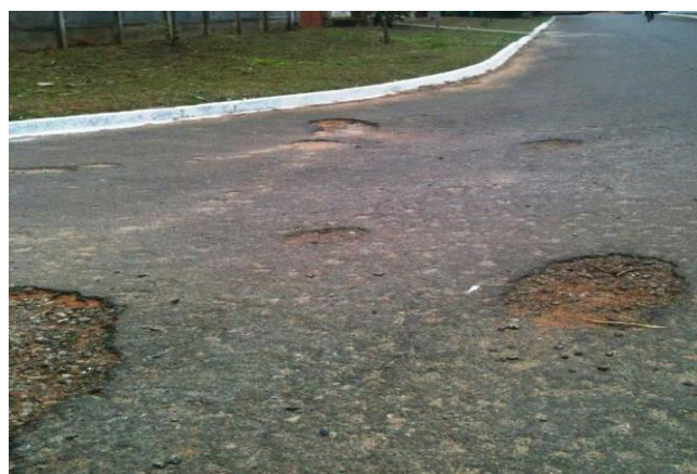
FIGURA 93 – DEFEITOS VISUAIS PRESENTES NO PAVIMENTO ASFÁLTICO.
