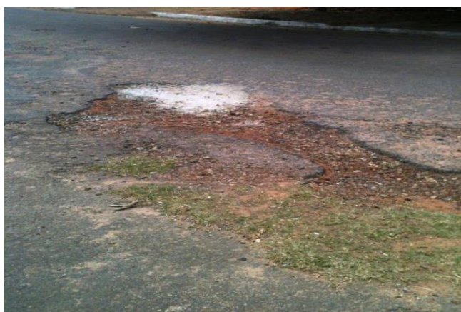
FIGURA 92 – DEFEITOS VISUAIS PRESENTES NO PAVIMENTO ASFÁLTICO.
