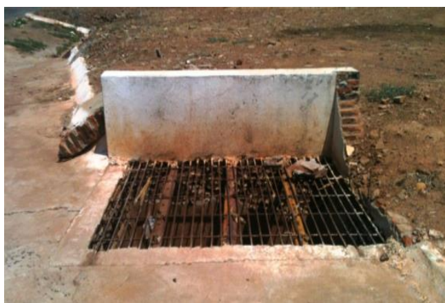
FIGURA 41 – BOCA DE LOBO DO MUNICÍPIO.
