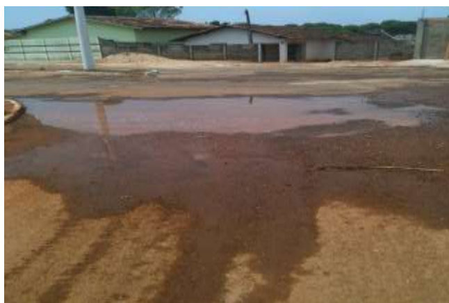
FIGURA 9 - ALAGAMENTO OCASIONADO PELA FALTA DE SISTEMA DE DRENAGEM PLUVIAL.
