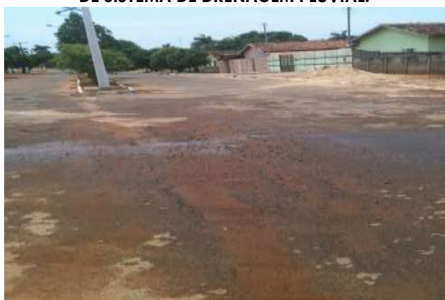
FIGURA 11 - DANIFICAÇÃO DA PAVIMENTAÇÃO ASFÁLTICA PELA FALTA DE DRENAGEM PLUVIAL.
