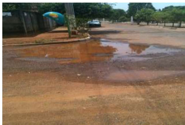
FIGURA 10 - ALAGAMENTO OCASIONADO PELA FALTA DE SISTEMA DE DRENAGEM PLUVIAL.
