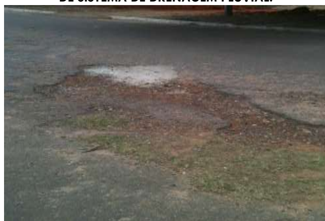
FIGURA 12 - EROSÕES CAUSADAS PELA FALTA DE SISTEMA DE DRENAGEM PLUVIAL.
