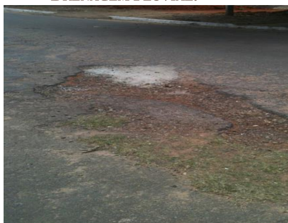
FIGURA 126 - EROSÕES CAUSADAS PELA FALTA DE SISTEMA DE DRENAGEM PLUVIAL.
