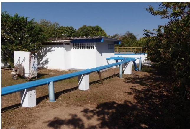
FIGURA 67 - ESTAÇÃO DE TRATAMENTO DE ÁGUA DE ITAPIRAPUÃ.
