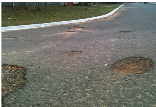
FIGURA 93 - DEFEITOS VISUAIS PRESENTES NO PAVIMENTO ASFÁLTICO.
