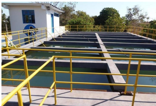
FIGURA 68 – TANQUES DE FLOCULAÇÃO.
