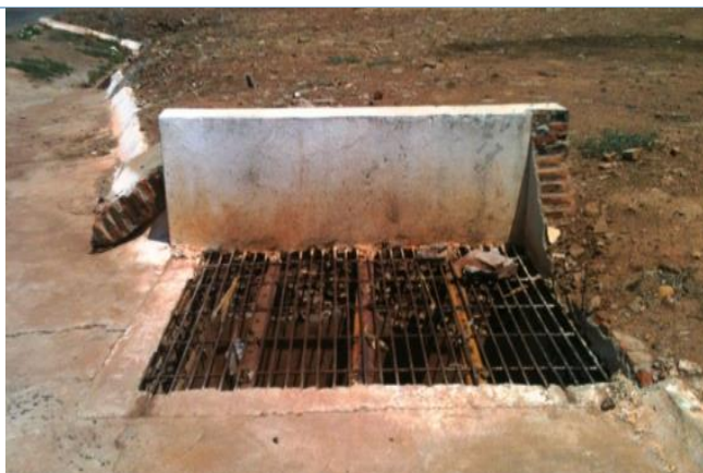
FIGURA 84 – ESTRUTURA DE MICRODRENAGEM.
