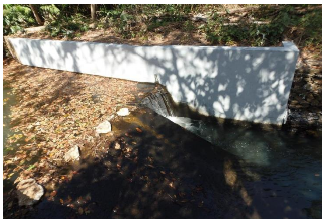
FIGURA 62 - CAPTAÇÃO DA ÁGUA BRUTA.
