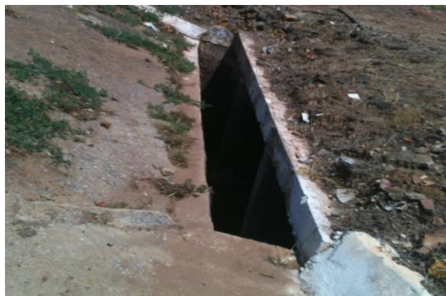
FIGURA 42 - BOCA DE LOBO DO MUNICÍPIO.
