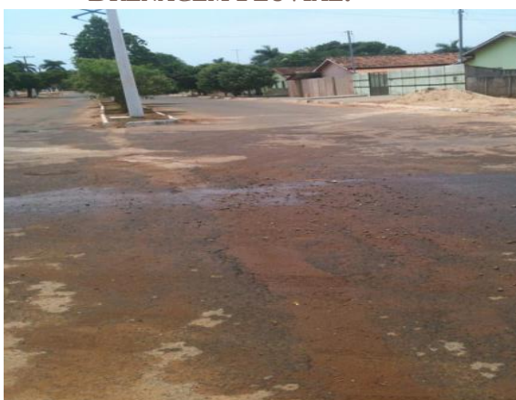
FIGURA 125 - DANIFICAÇÃO DA PAVIMENTAÇÃO ASFÁLTICA PELA FALTA DE DRENAGEM PLUVIAL.
