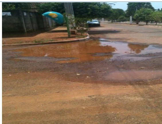
FIGURA 124 - ALAGAMENTO OCACIONADO PELA FALTA DE SISTEMA DE DRENAGEM PLUVIAL.
