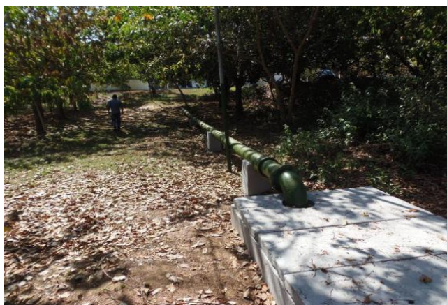
FIGURA 60 - CAPTAÇÃO DA ÁGUA BRUTA.
