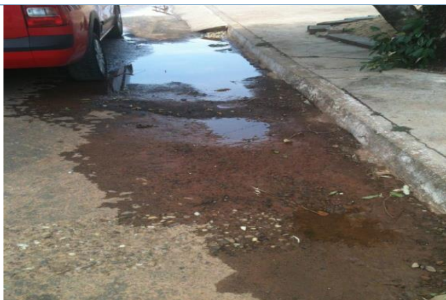
FIGURA 90 - EMPOÇAMENTO DAS RUAS DO MUNICÍPIO.
