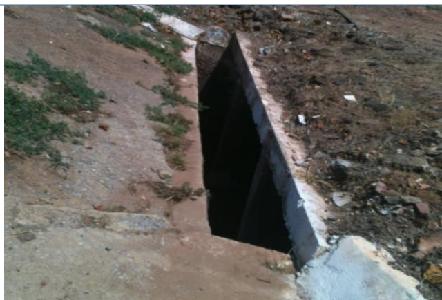
FIGURA 85 - ESTRUTURA DE MICRODRENAGEM.
