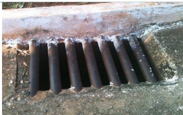
FIGURA 46 - BOCA DE LOBO DO MUNICÍPIO.
