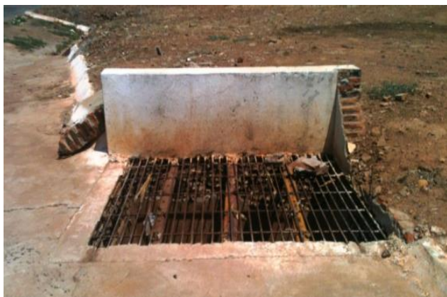
FIGURA 41 – BOCA DE LOBO DO MUNICÍPIO.
