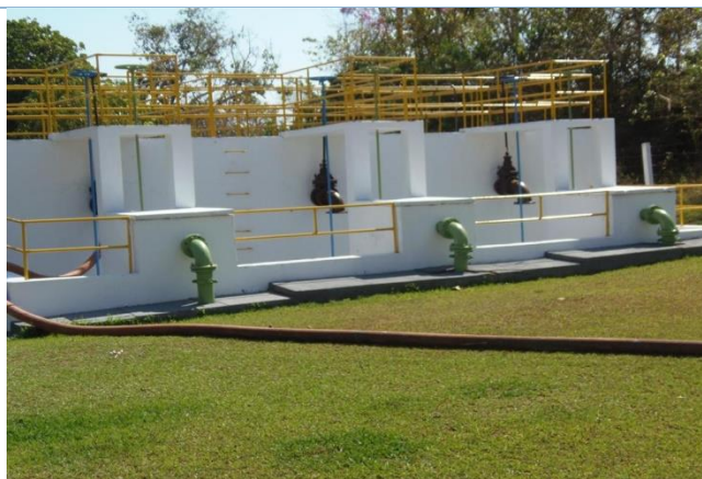
FIGURA 64 - ESTAÇÃO DE TRATAMENTO DE ÁGUA DE ITAPIRAPUÃ.
