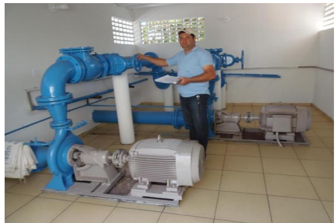
FIGURA 72 – CASA DE BOMBAS
