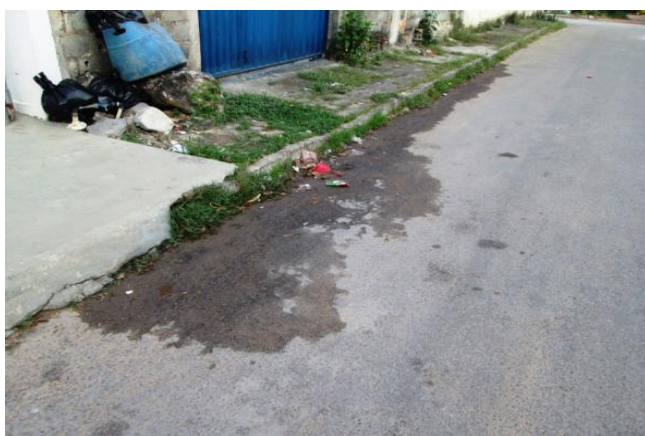
FIGURA 86 - ESTRUTURA DE MICRODRENAGEM.
