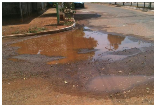
FIGURA 89 - EMPOÇAMENTO DAS RUAS DO MUNICÍPIO.
