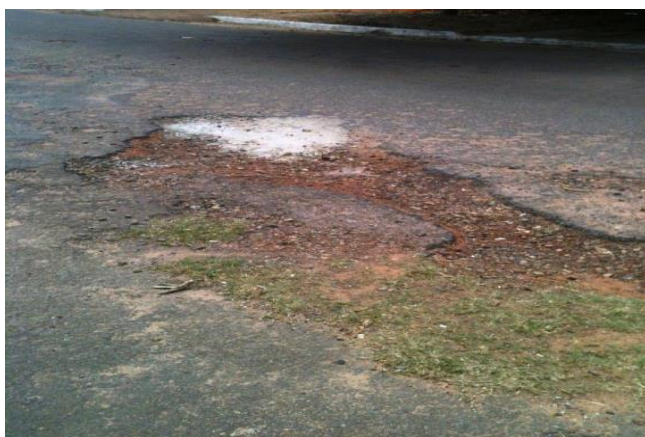
FIGURA 92 - DEFEITOS VISUAIS PRESENTES NO PAVIMENTO ASFÁLTICO.
