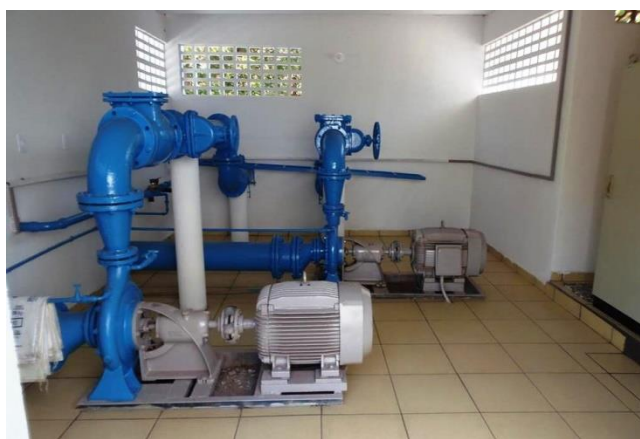
FIGURA 66 – CASA DE BOMBAS
