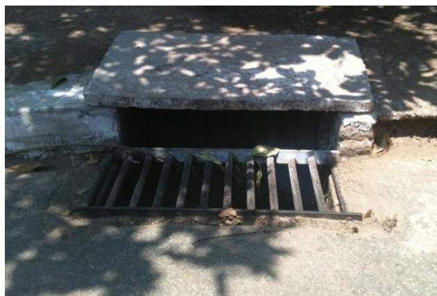
FIGURA 44 - BOCA DE LOBO DO MUNICÍPIO.
