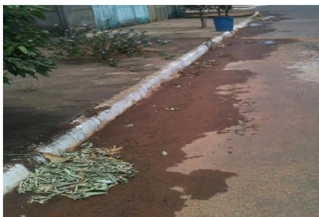
FIGURA 87 - ESTRUTURA DE MICRODRENAGEM.
