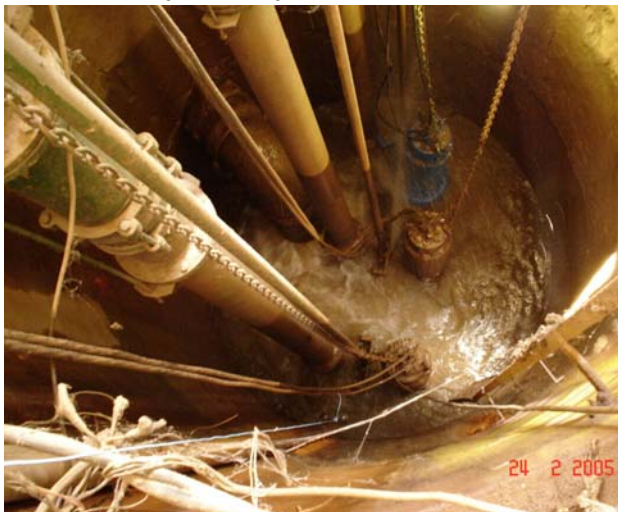
Foto 3.3 – Poço de sucção.
