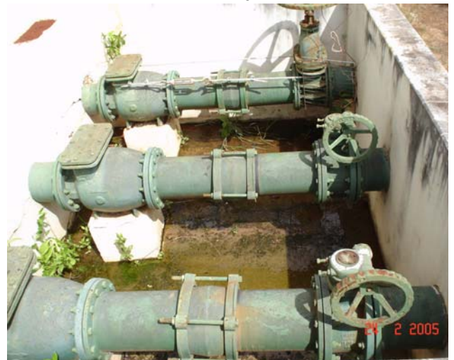
Foto 3.4 – Saída dos três conjuntos de bombas.
