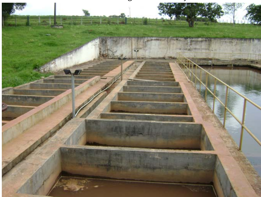
Foto 3.9 – Vista geral da floculação.
