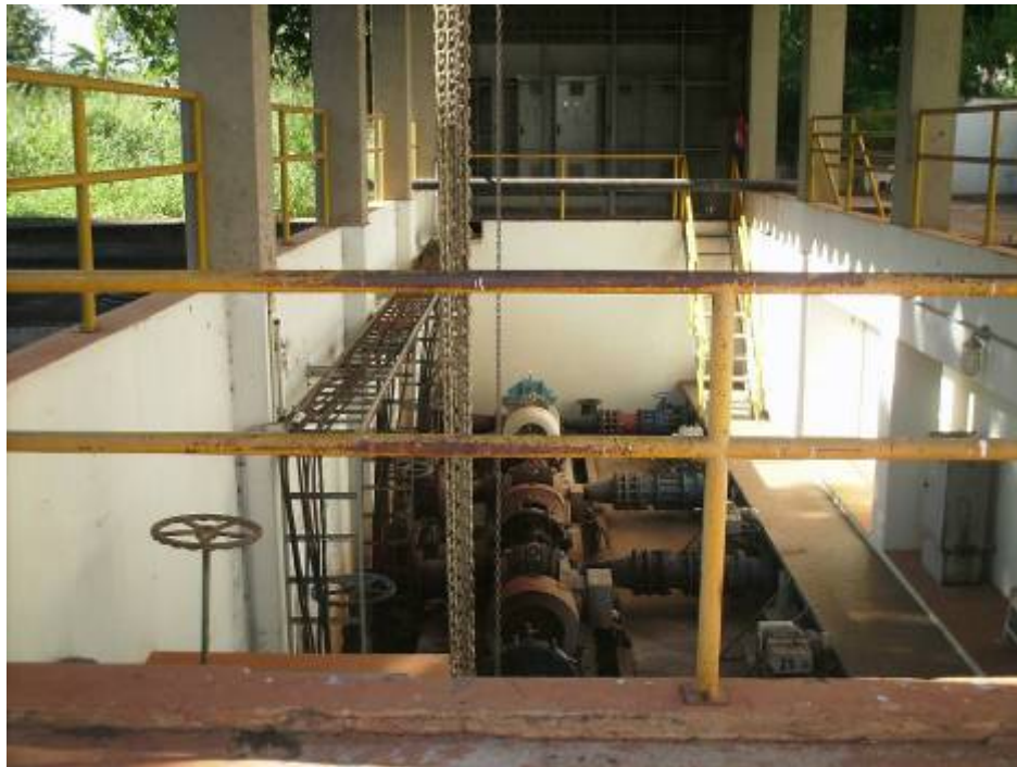
Foto 3.18 – Vista geral das bombas da EAT.
