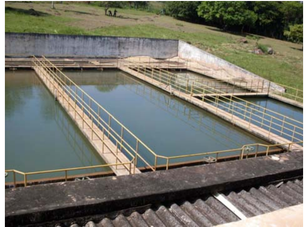
Foto 3.7 – Vista dos decantadores.
