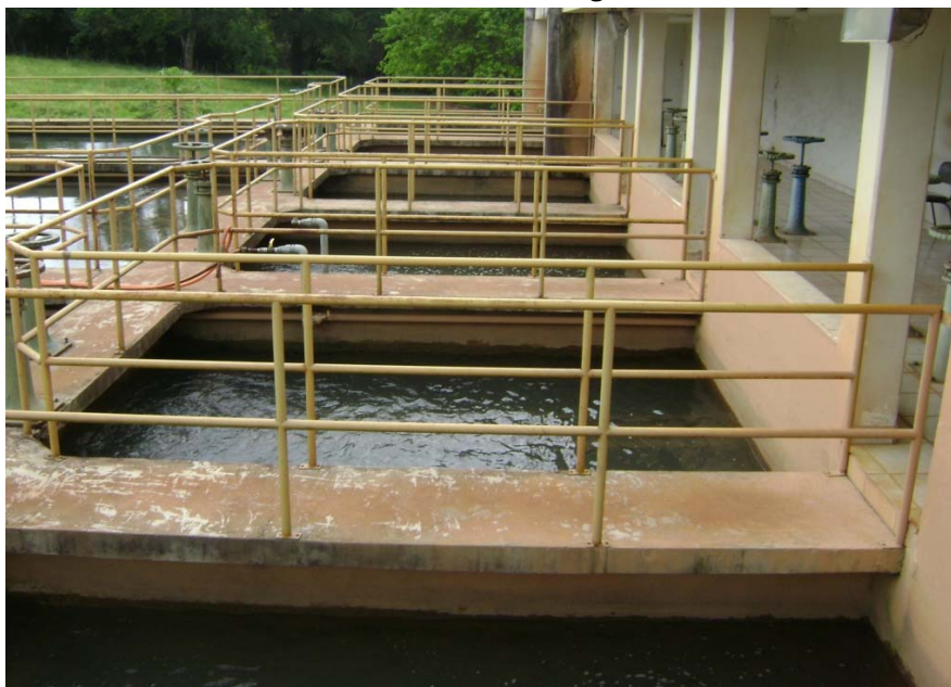
Foto 3.11 – Vista geral dos filtros.
