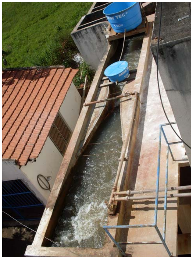
Foto 3.8 – Vista geral da calha Parshall.
