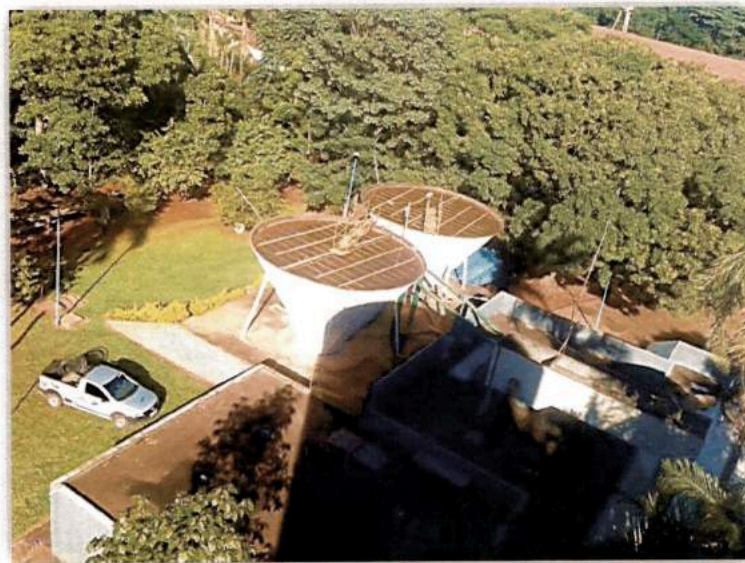
IMAGEM 49: Estação de Tratamento de Água de Nazário.
