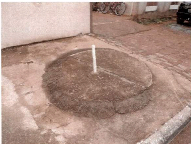
IMAGEM 28: Fossas residenciais localizada no passeio.
