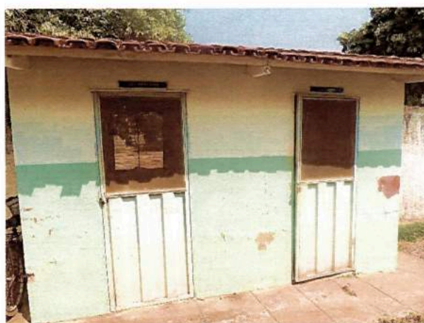
IMAGEM 42: Armazenamento Externo de RSS inadequado, fora das normas sanitárias.
