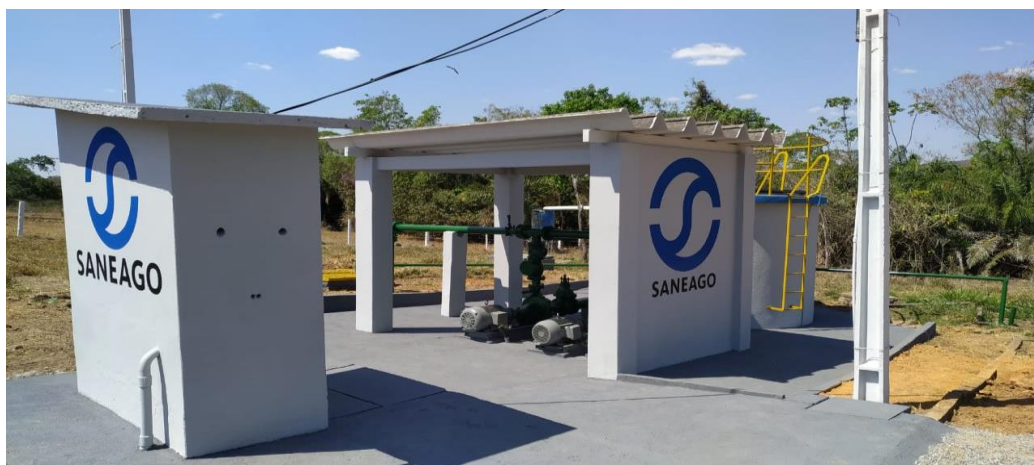
Conjunto de bombas e quadro de comando e poço de sucção. (Fonte: Arquivo Pessoal)
