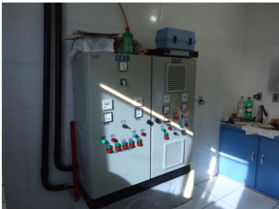
Figura 29 - Quadro de Comando
