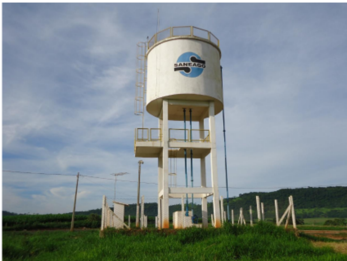
Figura 36 - Reservatório Elevado do Setor Dona Zízinha.
