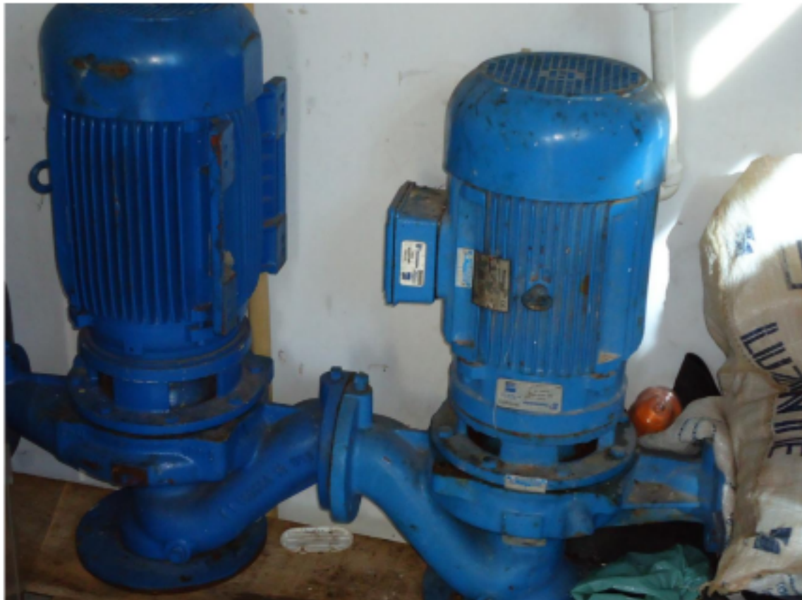
Figura 32 - Equipamento Reservado Para Bombeamento
