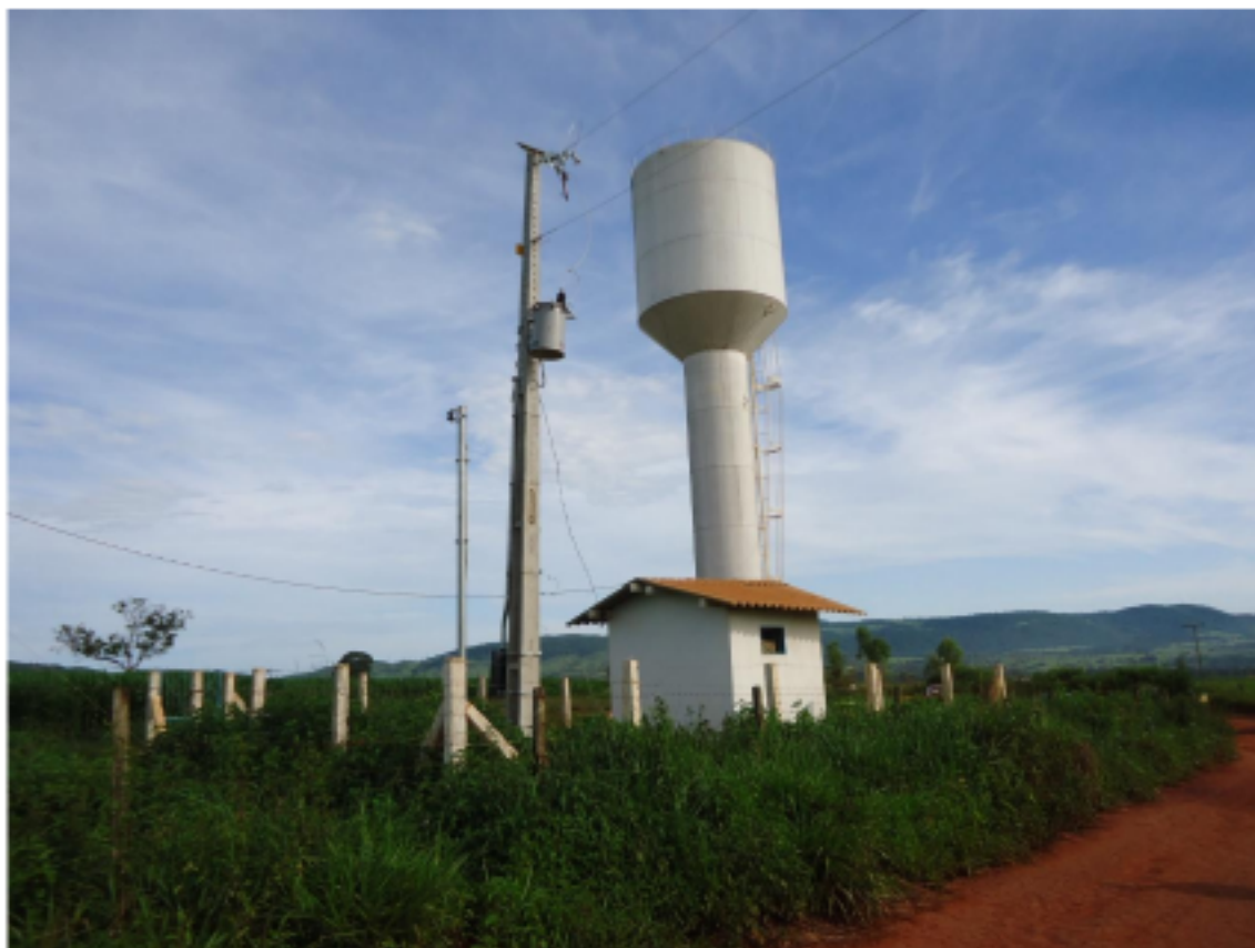
Figura 39 - Poço e reservatório do Assentamento Palmares
