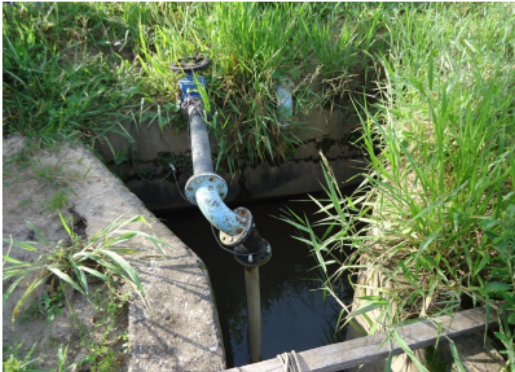
Figura 24- Bomba submersa para captação de água
