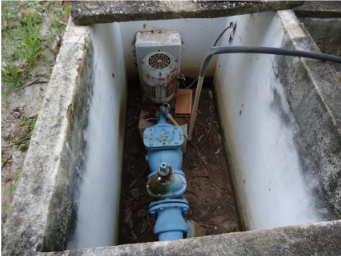
Figura 33 - Elevatória de Água Tratada
