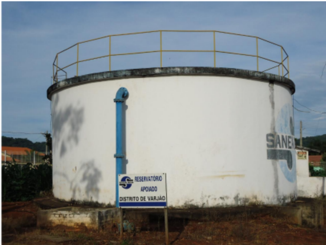
Figura 34 - Reservatório Apoiado Setor São Leopoldo
