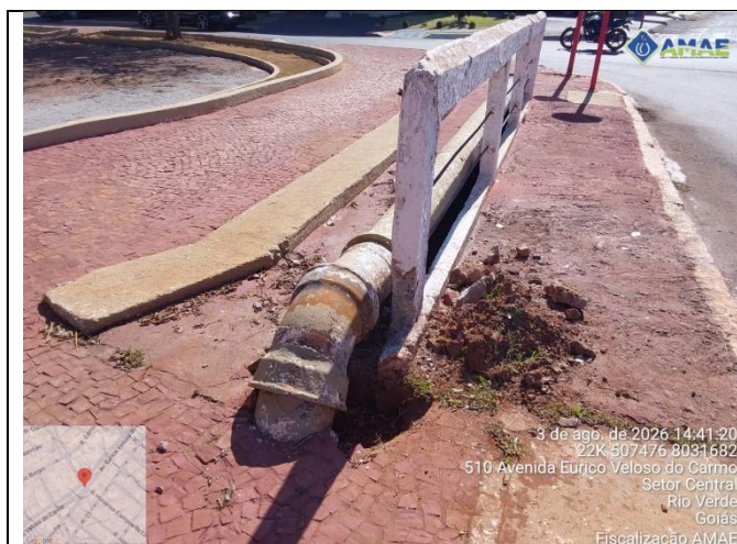
Figura 1 – Elemento fiscalizado: Rede adutora de água. Não conformidade: Calçamento danificado pelo vazamento. Data do registro fotográfico: 03/08/2026
