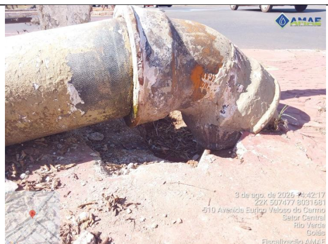
Figura 2 – Elemento fiscalizado: Rede adutora de água. Não conformidade: Pequeno vazamento de água e permanência de desalinhamento na conexão. Data do registro fotográfico: 03/08/2026
