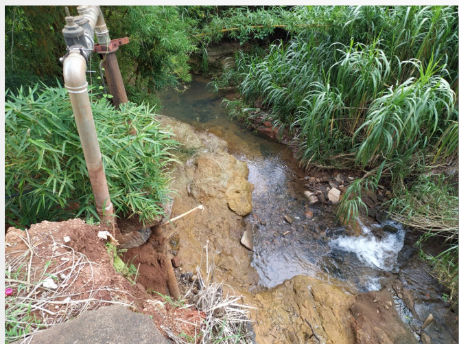
Figura 7 – Poço artesiano com estrutura deteriorada
